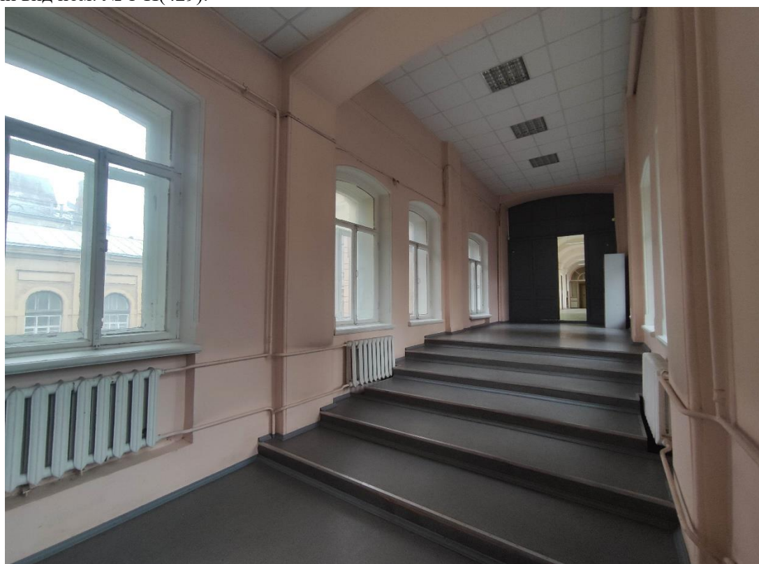
56. Часть объекта культурного наследия «Здания, в которых 1885-1918 гг. находились Высшие женские (Бестужевские) курсы. Здесь преподавали Бестужев-Рюмин К.Н., Менделеев Д.И., Бутлеров А.М., Сеченов И.М. и другие деятели науки» по адресу: Санкт-Петербург, 10-я линия В.О., дом 31-33, литера А. Общий вид пом. № 1-Н(370).
