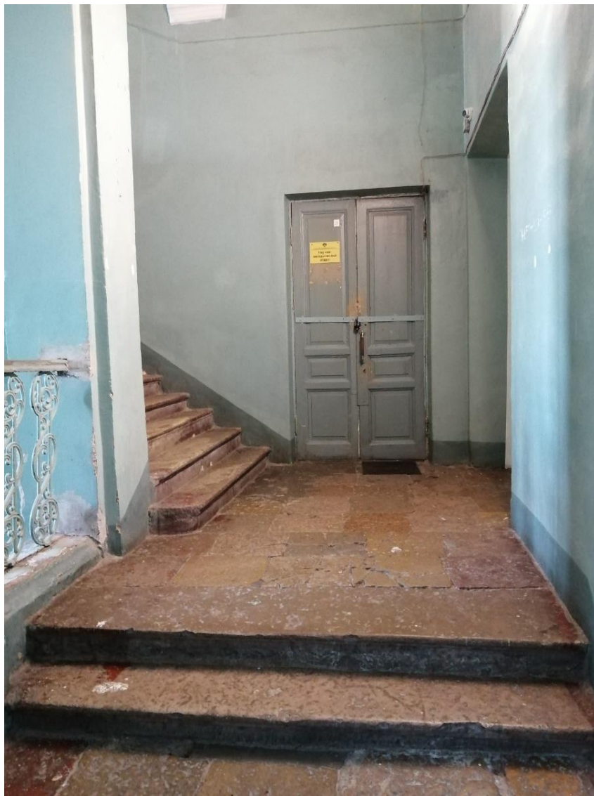
16. Объект культурного наследия федерального значения «Корпус для игры в мяч ("жедепом")», расположенный по адресу: г. Санкт-Петербург, Университетская набережная, дом 7-9-11, литера О. Фрагмент парадной лестницы Л1, пом. № 1-Н(88).
