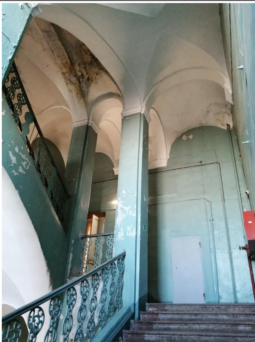
15. Объект культурного наследия федерального значения «Корпус для игры в мяч ("жедепом")», расположенный по адресу: г. Санкт-Петербург, Университетская набережная, дом 7-9-11, литера О. Общий вид парадной лестницы Л1, пом. № 1-Н(88).
