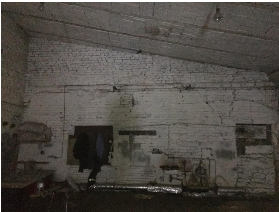
Фото 6. Выявленный объект культурного наследия «Доходные дома М.С. Воронина», расположенный по адресу: Санкт-Петербург, Адмиралтейский район, наб. реки Мойки, д. 82, литера А, Б, Ш. Надворный флигель (литера Ш), помещение 41(Н), внутренняя перегородка, разделяющая помещения флигеля.
