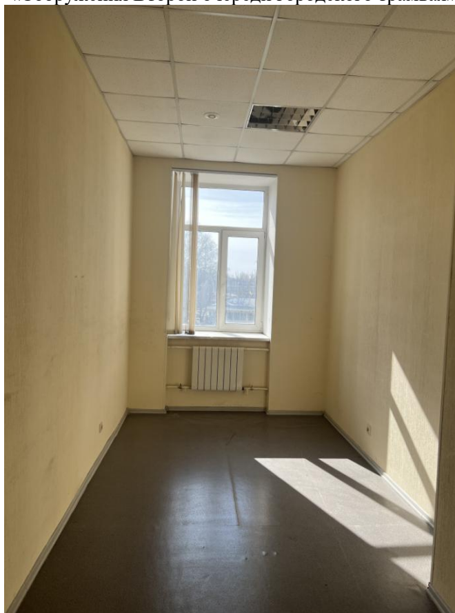
Фото 26. Интерьер второго этажа выявленного объекта культурного наследия «Административное здание», входящего в состав выявленного объекта культурного наследия «Сооружения Второй очереди городского трамвая»
