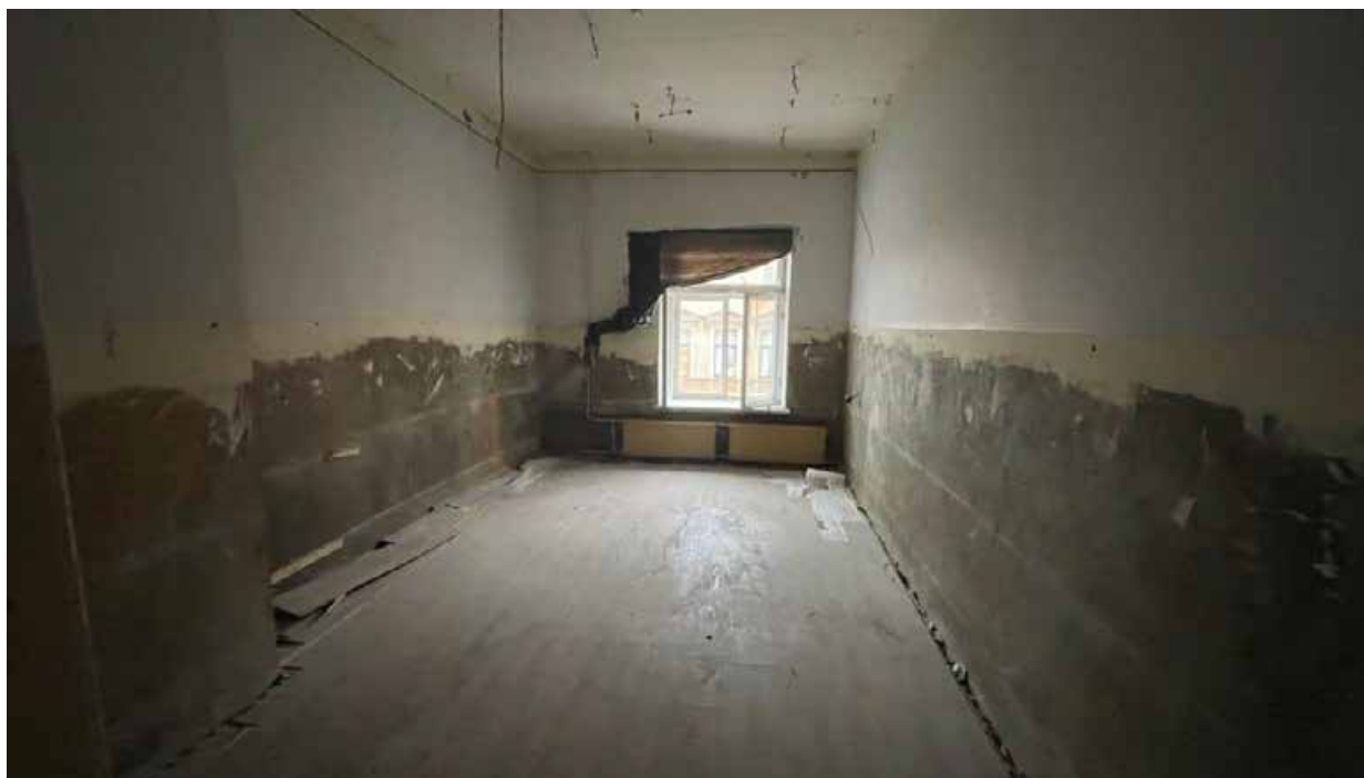
243. Фрагмент интерьера офисного помещения на третьем этаже;
