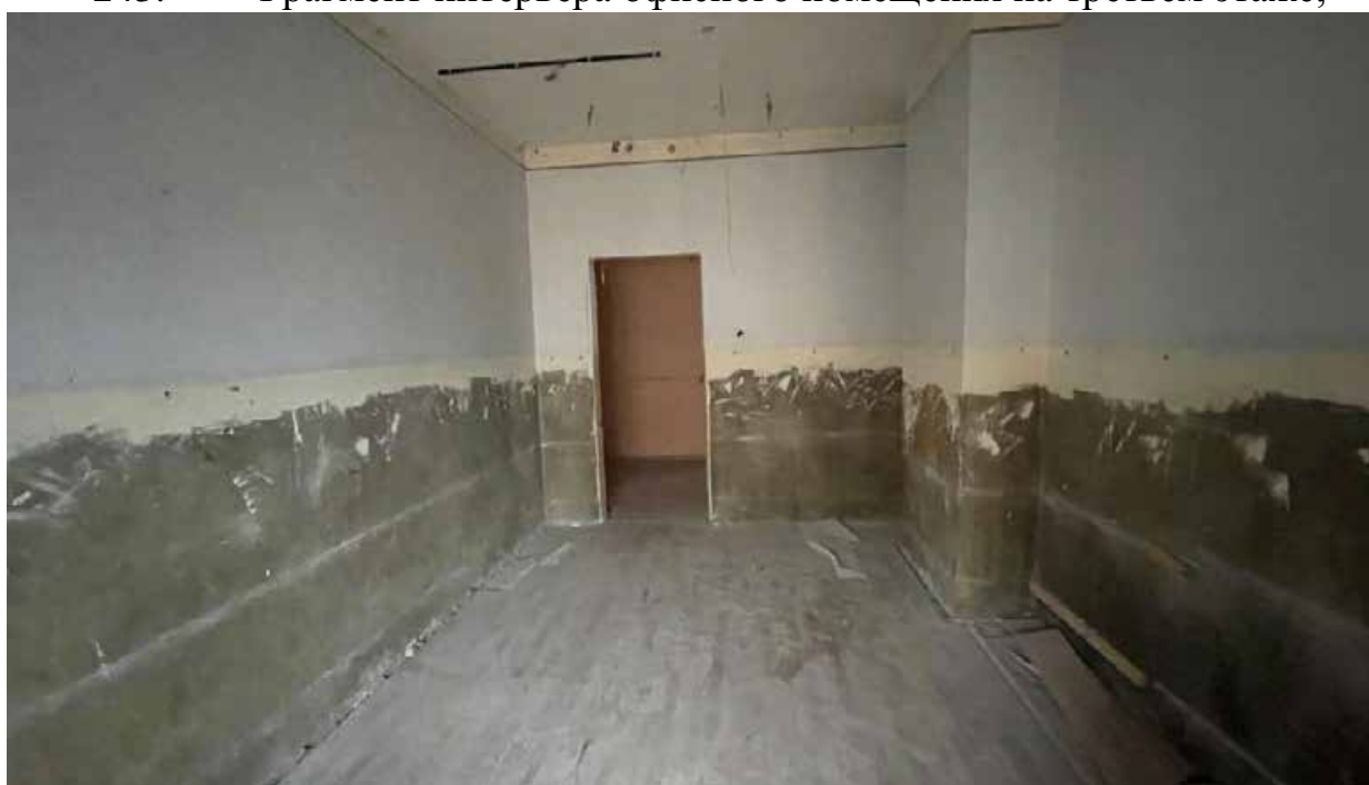
244. Фрагмент интерьера офисного помещения на третьем этаже;
