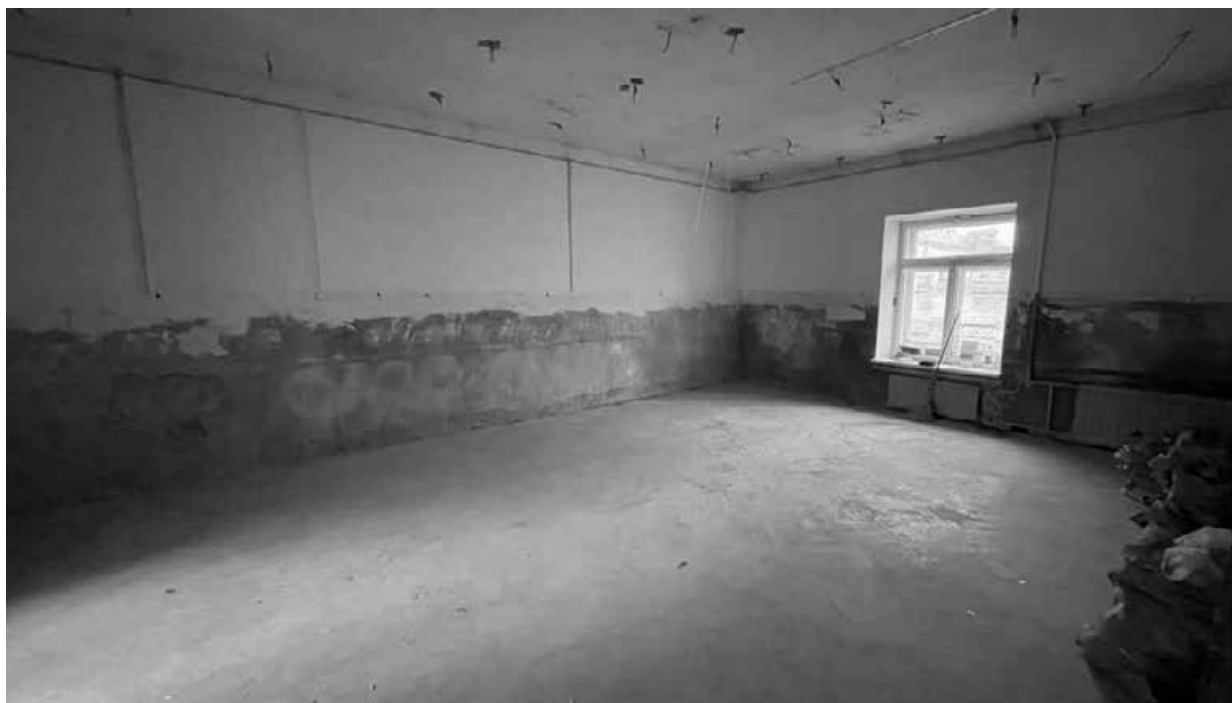
246. Фрагмент интерьера офисного помещения на третьем этаже;
