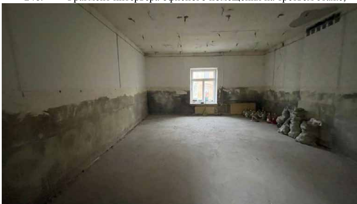
247. Фрагмент интерьера офисного помещения на третьем этаже;
