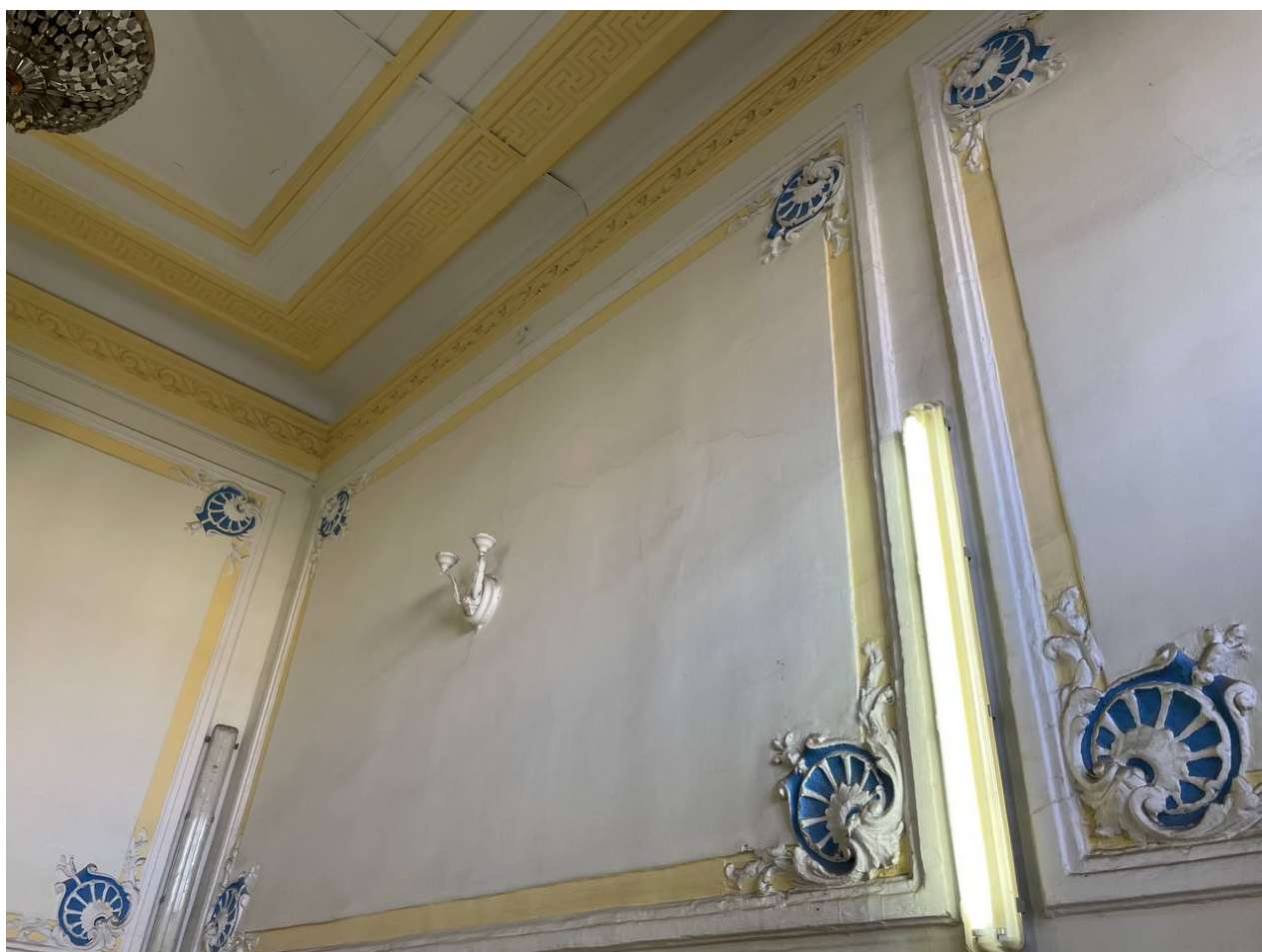
Фото 30. Фрагмент помещения. Наблюдается отслоение штукатурного слоя, волосяные трещины и загрязнение.
