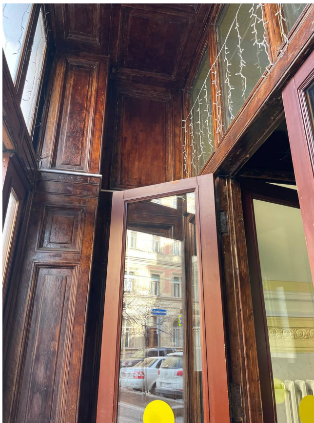
Фото 5. Вид на фрагмент входной группы. Видны несоответствия исторической окраски.
