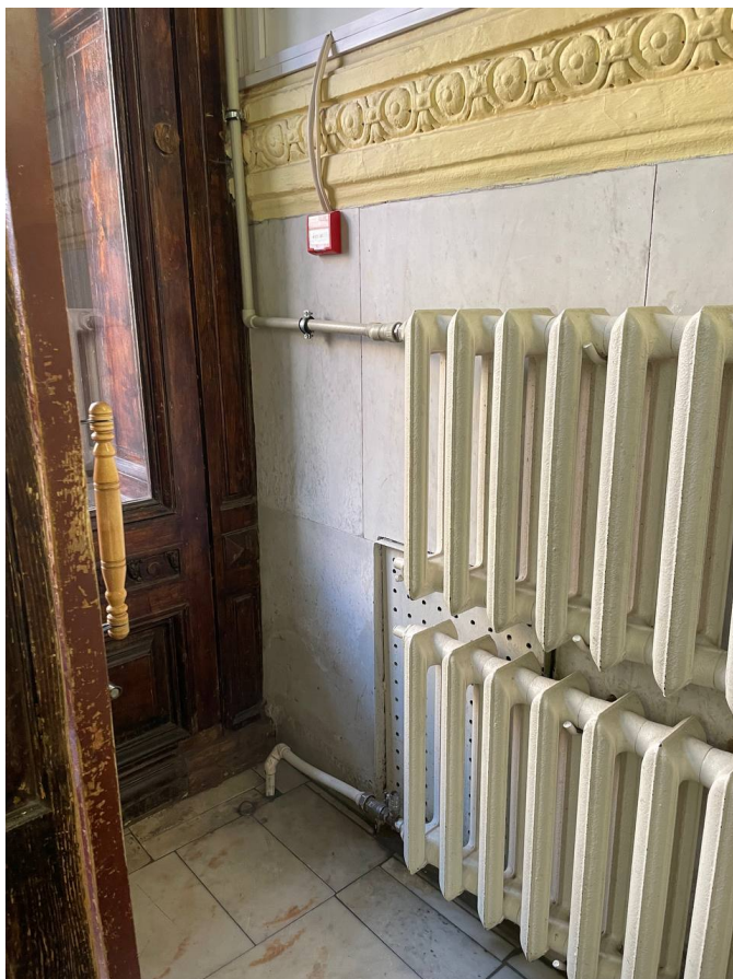
Фото 35. Фрагмент помещения. Отопительные приборы.
