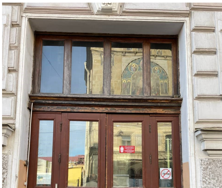
Фото 4. О Фрагмент дверного заполнения, наблюдается отслоение окрасочного слоя, загрязнение.
