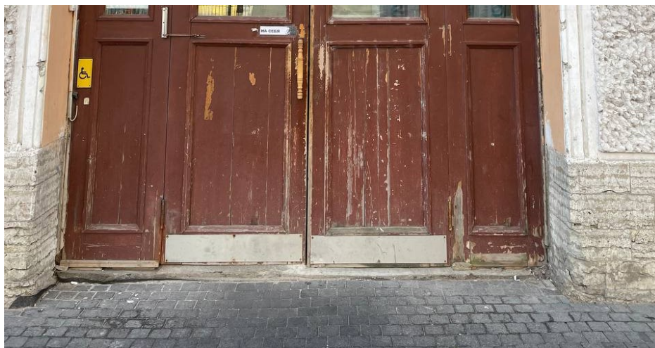
Фото 3. Фрагмент дверного заполнения, наблюдается отслоение окрасочного слоя, загрязнение.
