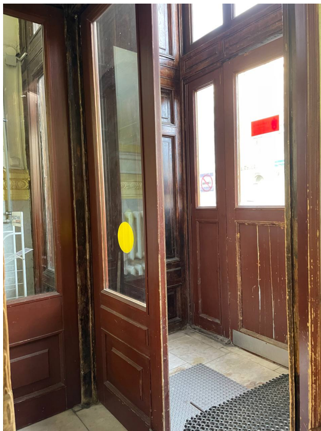
Фото 13. Вид на фрагмент входной группы. Видны несоответствия исторической окраски.
