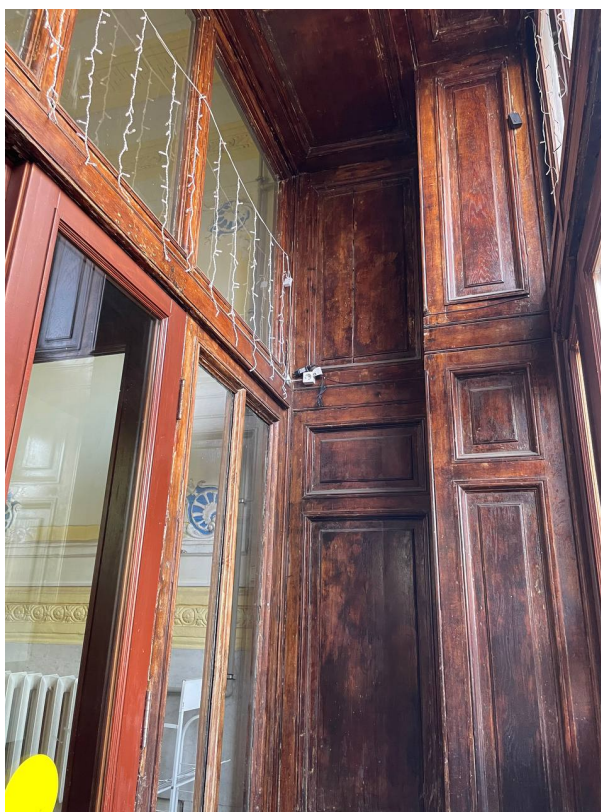
Фото 6. Вид на фрагмент входной группы. Видны несоответствия исторической окраски.
