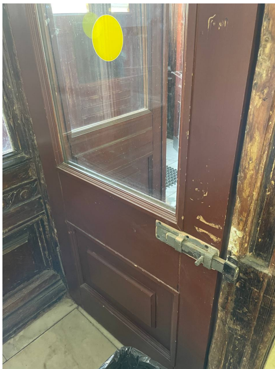
Фото 9. Вид на фрагмент входной группы. Наблюдается отслоение окрасочного слоя, загрязнение.
