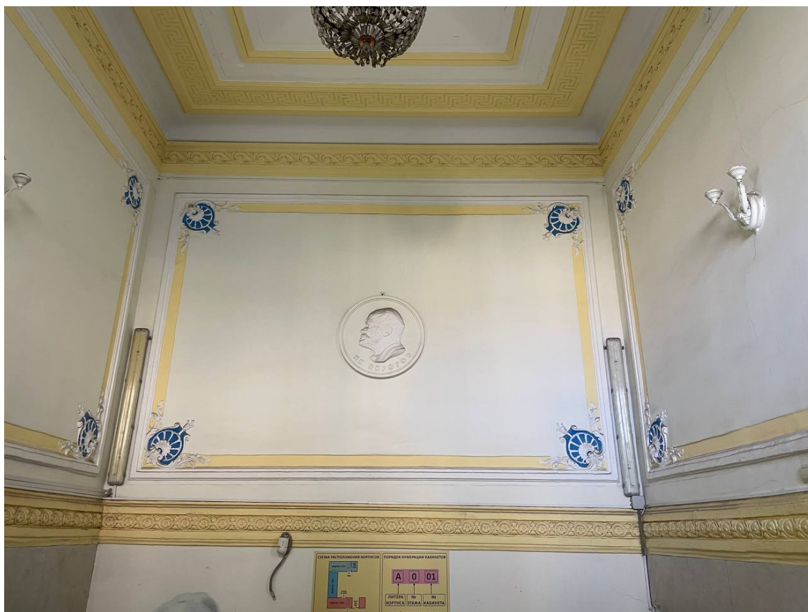
Фото 28. Фрагмент помещения. Наблюдается отслоение штукатурного слоя, волосяные трещины и загрязнение.
