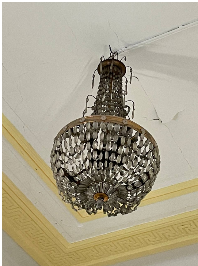
Фото 31. Фрагмент помещения. Наблюдается отслоение штукатурного слоя, волосяные трещины и загрязнение.
