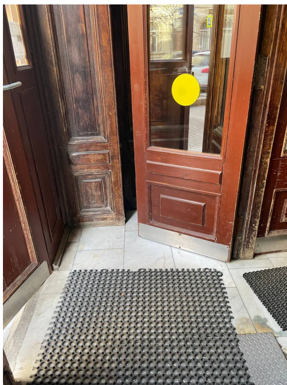
Фото 14 Вид на фрагмент входной группы. Видны несоответствия исторической окраски.
