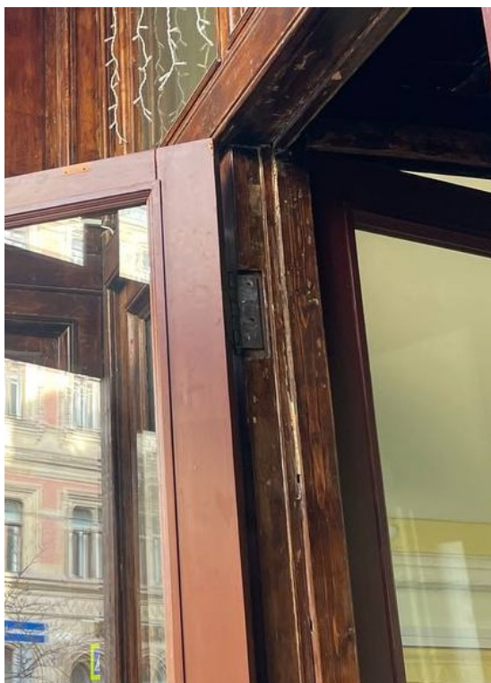
Фото 12. Вид на фрагмент входной группы. Видны несоответствия исторической окраски.
