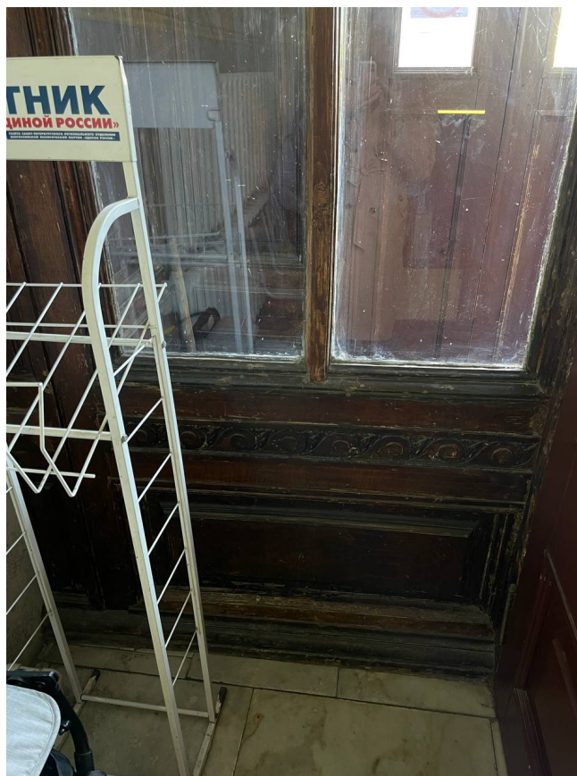
Фото 16. Вид на фрагмент входной группы. Наблюдается отслоение окрасочного слоя, загрязнения.
