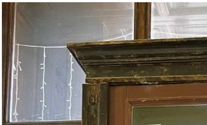
Фото 20. Вид на фрагмент входной группы. Видны несоответствия исторической окраски, отслоение окрасочного слоя, загрязнения.
