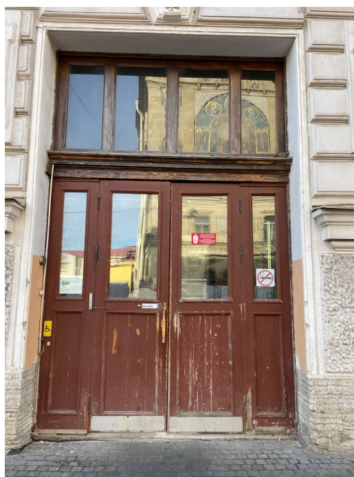
Фото 2. Общий вид на главный вход с ул. Правды. Видны несоответствия исторической окраски.
