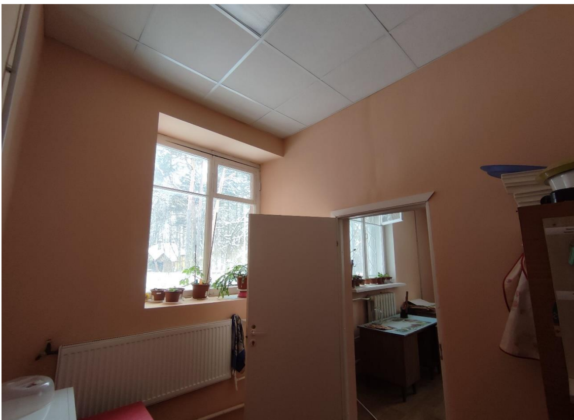
15. Объект культурного наследия федерального значения «Корпус Конюшенный», по адресу: Санкт-Петербург, г. Пушкин, Московское ш., д. 11 (Санкт-Петербург, г. Пушкин, Московское ш., д. 5, лит. Б). Общий вид пом. 5-Н (4) в уровне 1-го этажа.
