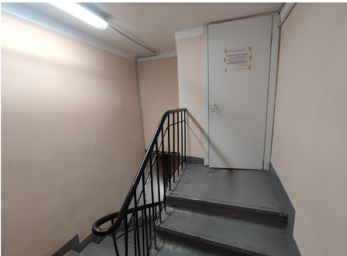
27. Объект культурного наследия федерального значения «Корпус Конюшенный», по адресу: Санкт-Петербург, г. Пушкин, Московское ш., д. 11 (Санкт-Петербург, г. Пушкин, Московское ш., д. 5, лит. Б). Общий вид пом. 6-Н (4) в уровне 2-го этажа.
