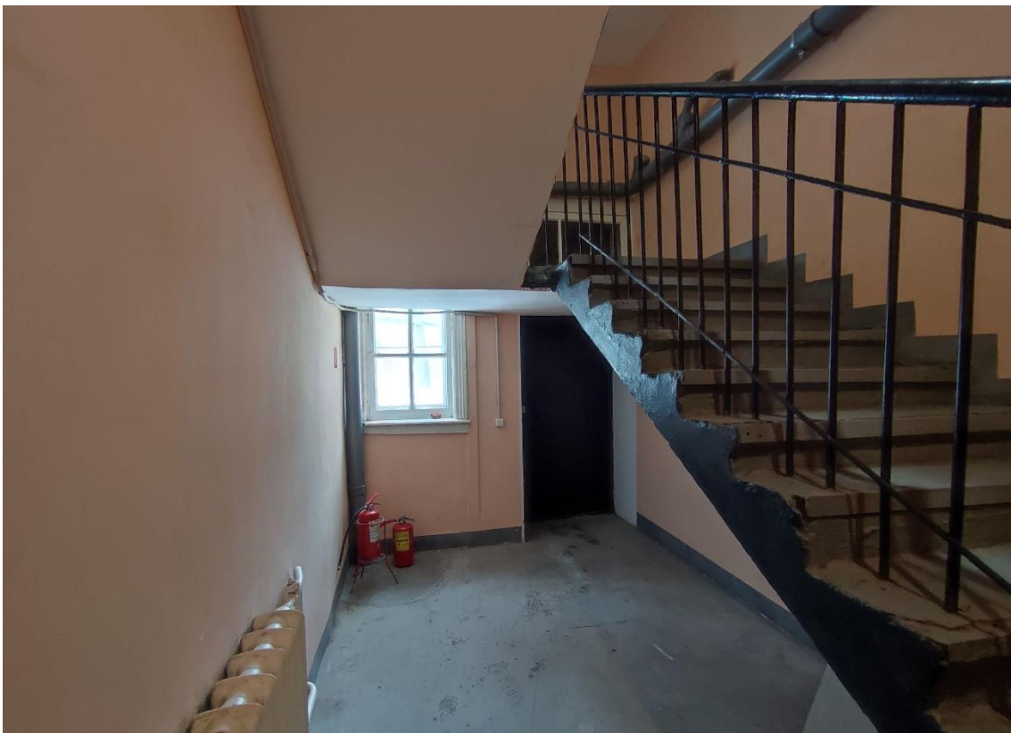
21. Объект культурного наследия федерального значения «Корпус Конюшенный», по адресу: Санкт-Петербург, г. Пушкин, Московское ш., д. 11 (Санкт-Петербург, г. Пушкин, Московское ш., д. 5, лит. Б). Общий вид пом. 6-Н (1, 2) в уровне 1-го этажа.
