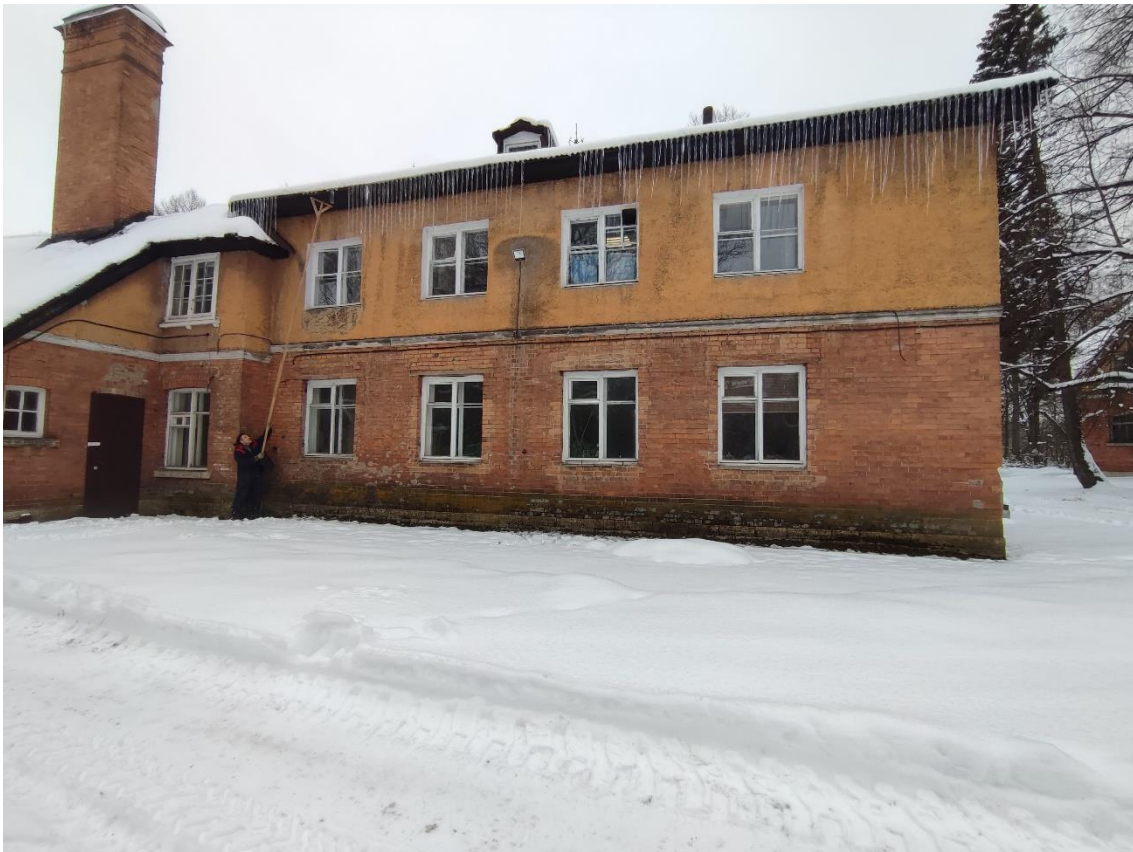
7. Объект культурного наследия федерального значения «Корпус Конюшенный», по адресу: Санкт-Петербург, г. Пушкин, Московское ш., д. 11 (Санкт-Петербург, г. Пушкин, Московское ш., д. 5, лит. Б). Фрагмент северо-восточного фасада.
