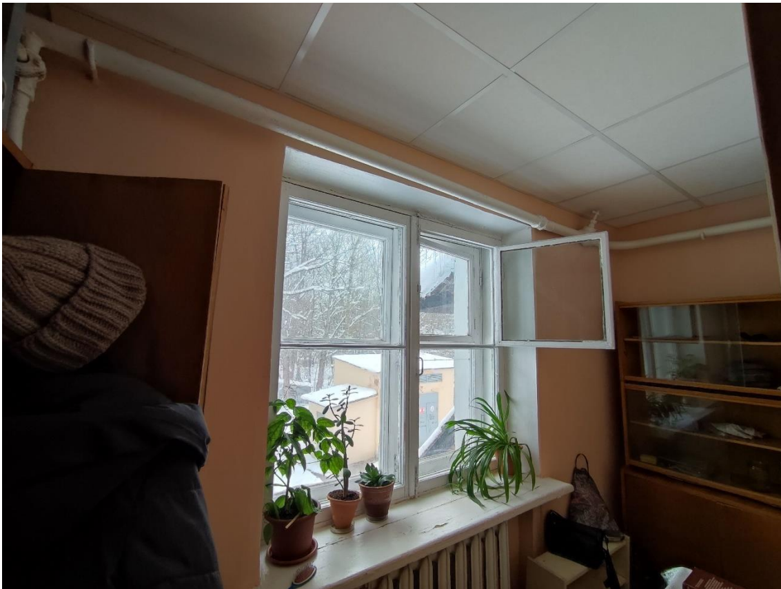
34. Объект культурного наследия федерального значения «Корпус Конюшенный», по адресу: Санкт-Петербург, г. Пушкин, Московское ш., д. 11 (Санкт-Петербург, г. Пушкин, Московское ш., д. 5, лит. Б). Фрагмент пом. 6-Н (27) в уровне 2-го этажа.
