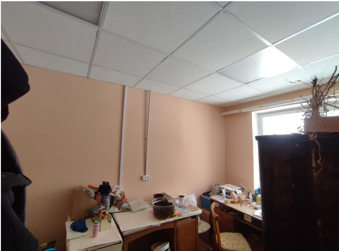
33. Объект культурного наследия федерального значения «Корпус Конюшенный», по адресу: Санкт-Петербург, г. Пушкин, Московское ш., д. 11 (Санкт-Петербург, г. Пушкин, Московское ш., д. 5, лит. Б). Общий вид пом. 6-Н (26) в уровне 2-го этажа.
