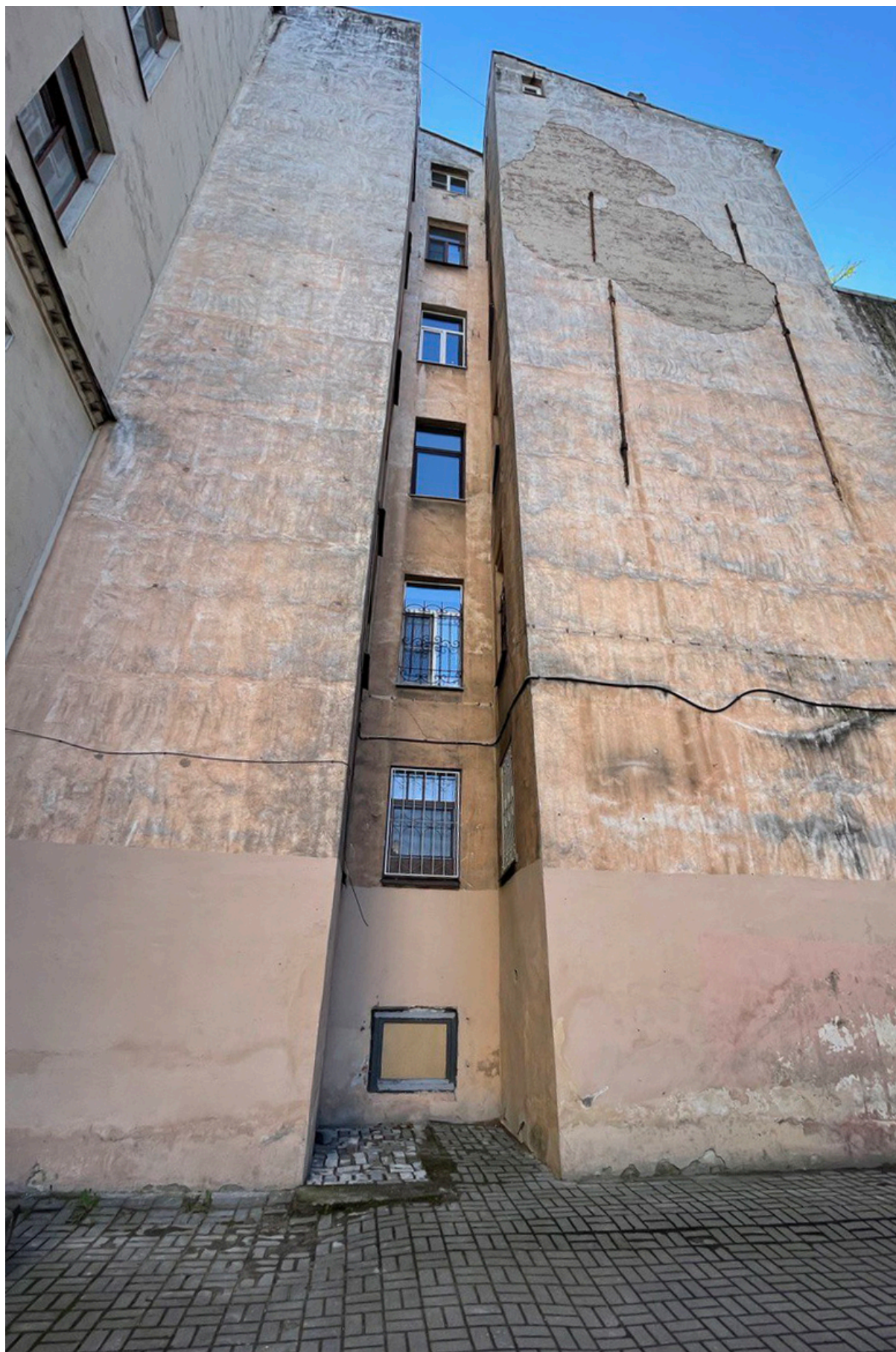
Фото 8 – Фрагмент фасада с окном 1050х1210мм. Заложенная подоконная часть.
