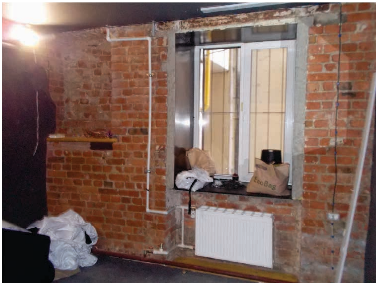
Фото 3 – Внешний вид окна 1120x1750мм со стороны помещения. Ниша под окном.
