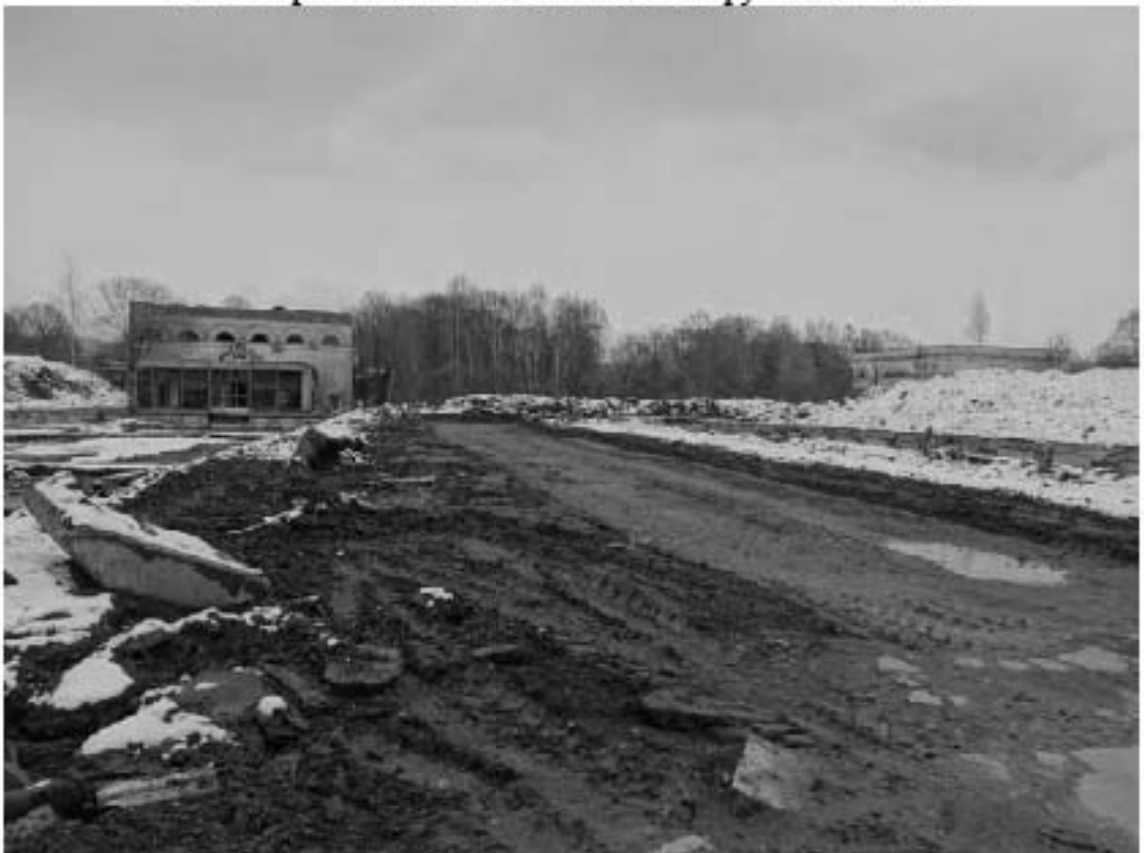
Фото 10. Объект культурного наследия федерального значения «Сад Таврический с прудом», входящий в состав объекта культурного наследия федерального значения «Дворец Таврический». Территория 2-го этапа работ. Вид на восток. Съемка 28.03.2023 г. Трушковский В.Э.
