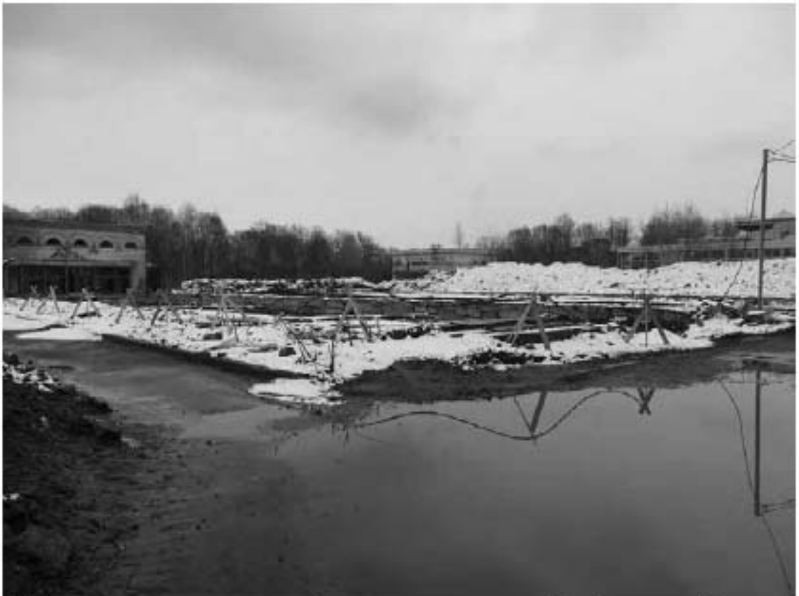
Фото 7. Объект культурного наследия федерального значения «Сад Таврический с прудом», входящий в состав объекта культурного наследия федерального значения «Дворец Таврический». Территория 2-го этапа работ. Вид на восток. Съемка 28.03.2023 г. Трушковский В.Э.
