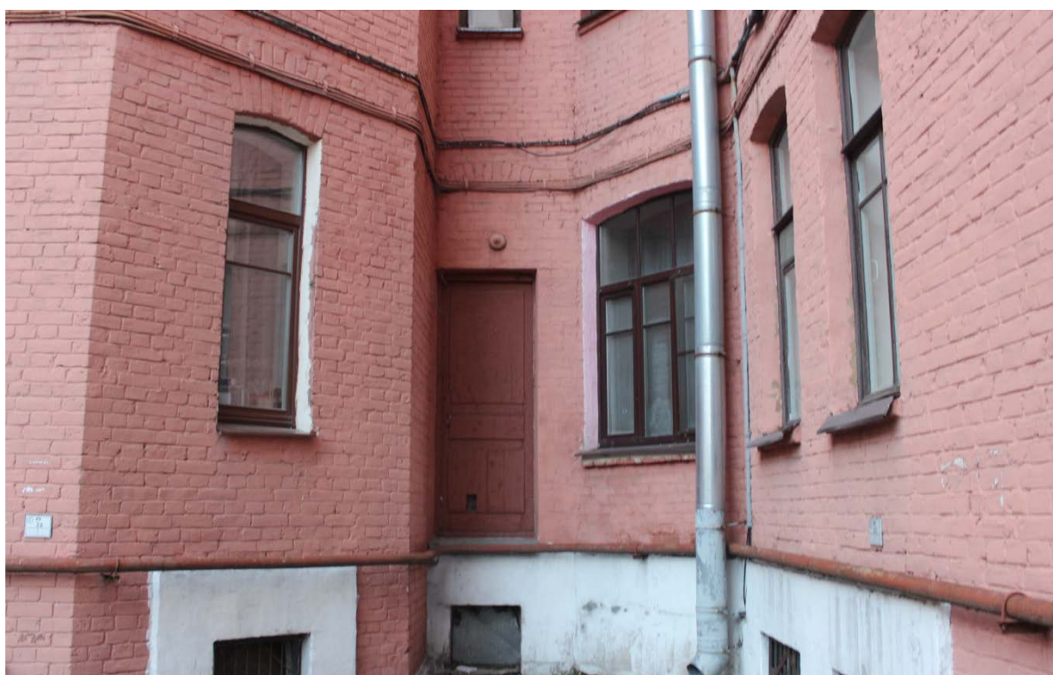
7. Фрагменты восточного и западного дворового фасада здания по адресу: Санкт-Петербург, проспект Обуховской обороны, д. 33, Лит. А. В центре на фото – дверной проем, переоборудованный из оконного проема.
