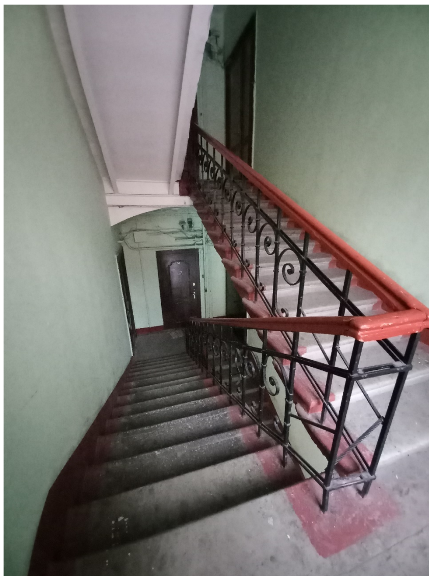
15. . Здание по адресу: Санкт-Петербург, проспект Обуховской обороны, д. 33, Лит. А. Общий вид парадную лестничную клетку ЛК-4. Пролет между 2-м и 3-м этажами.
