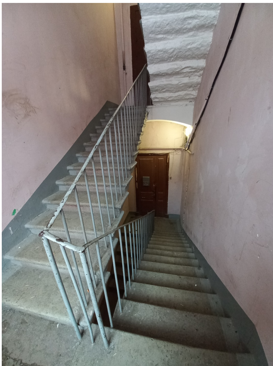
17. Здание по адресу: Санкт-Петербург, проспект Обуховской обороны, д. 33, Лит. А. Общий вид парадную лестничную клетку ЛК-5. Пролет между 2-м и 3-м этажами.
