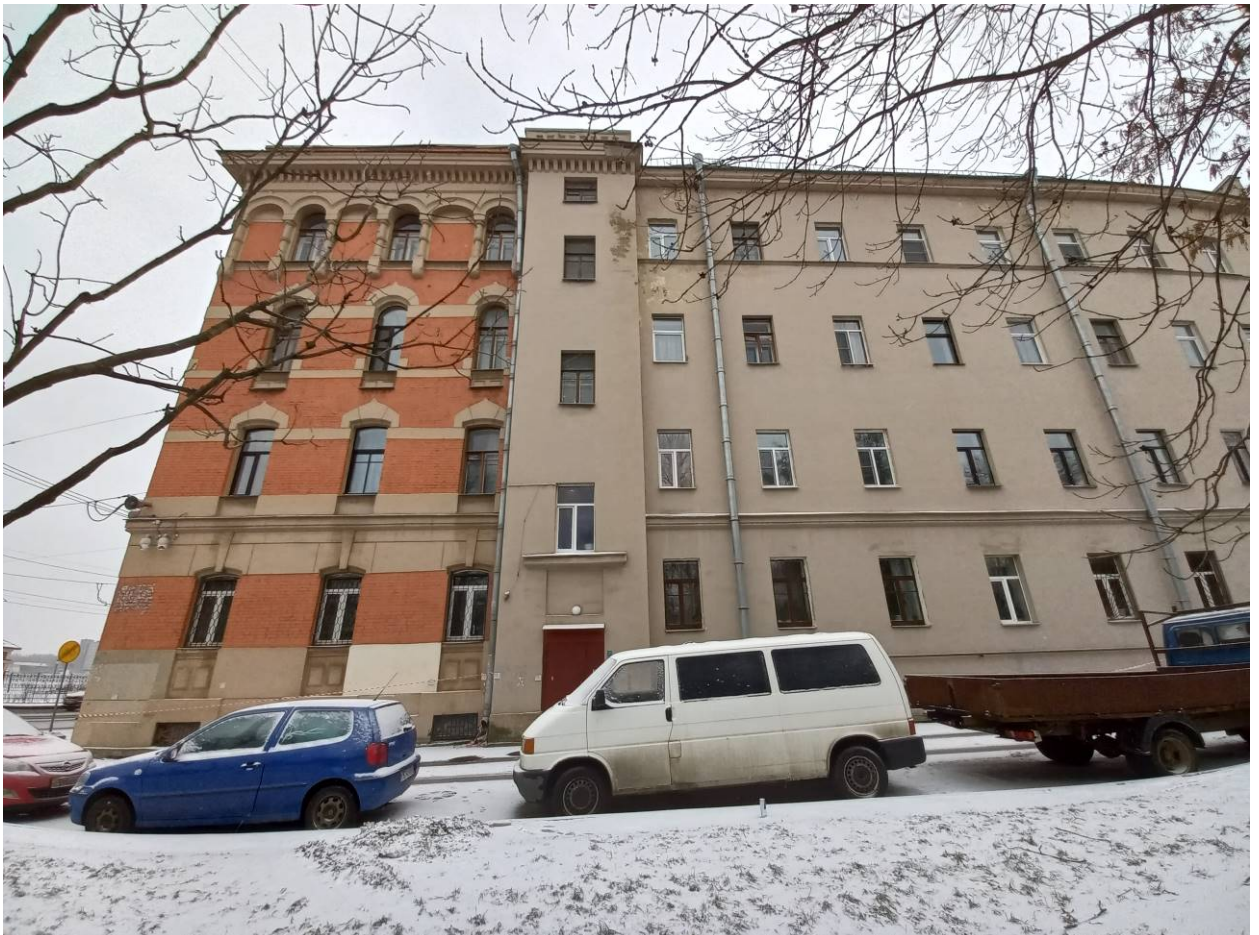
2. Общий вид западного лицевого фасада здания по адресу: Санкт-Петербург, проспект Обуховской обороны, д. 33, Лит. А. Восточный фрагмент.
