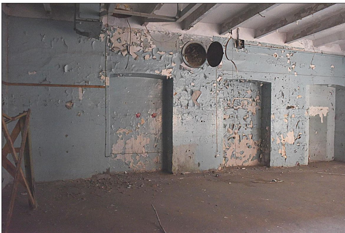
16. Выявленный объект культурного наследия «Здание, в котором размещались издательство и типография Ф.А. Брокгауза и И.А. Ефрон». Помещение 7 3-го этажа
