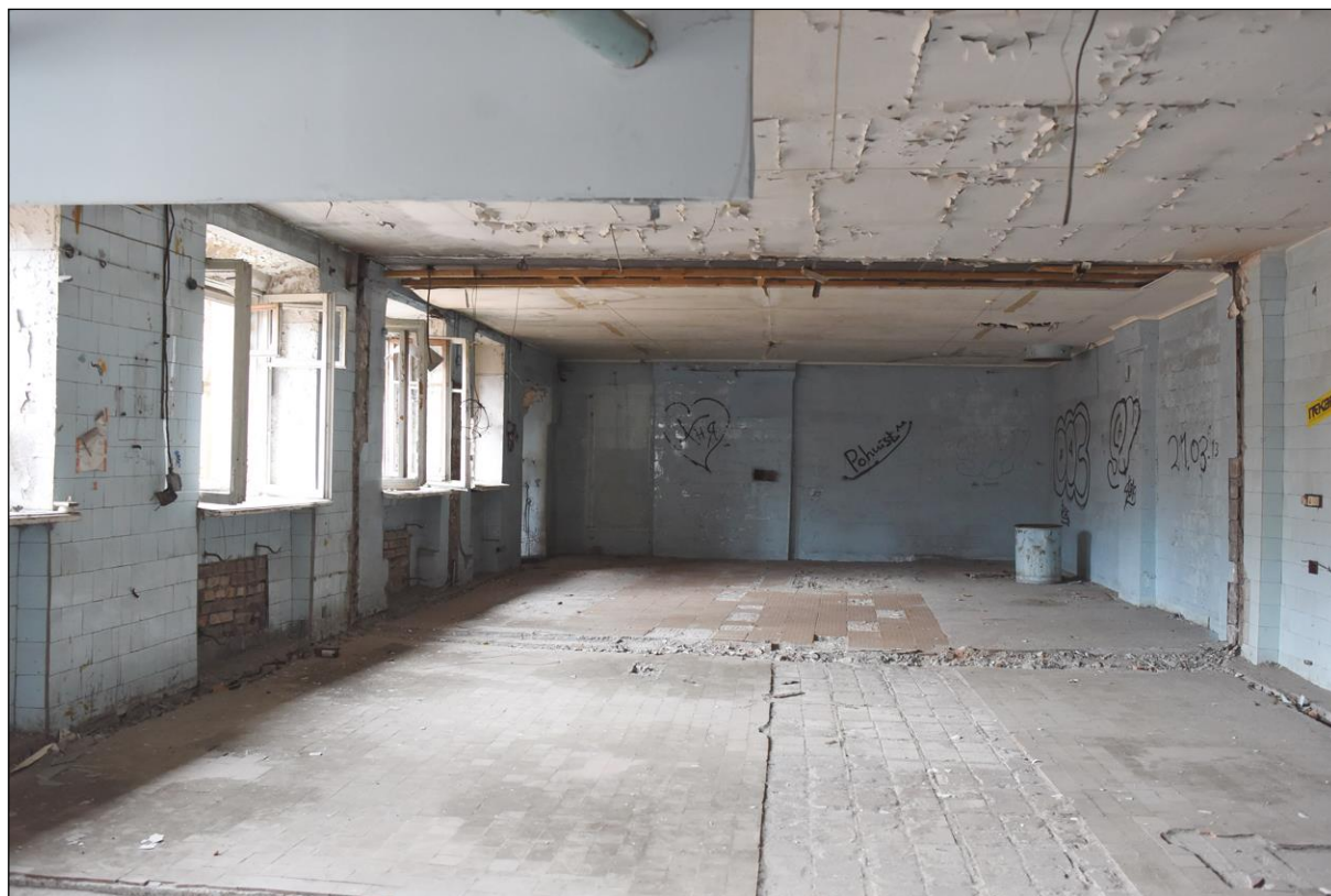
17. Выявленный объект культурного наследия «Здание, в котором размещались издательство и типография Ф.А. Брокгауза и И.А. Ефрон». Помещения 4-го этажа южного дворового флигеля. Часть перегородок демонтирована.
