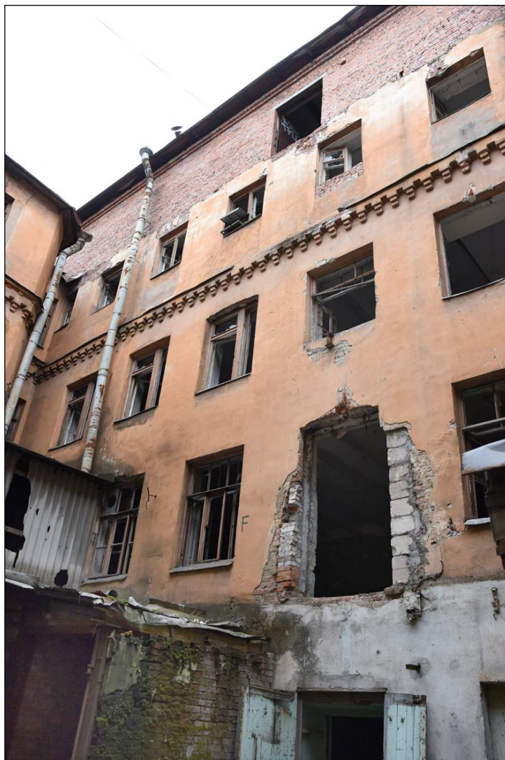
8. Выявленный объект культурного наследия «Здание, в котором размещались издательство и типография Ф.А. Брокгауза и И.А. Ефрон». Фрагмент северного дворового фасада.
