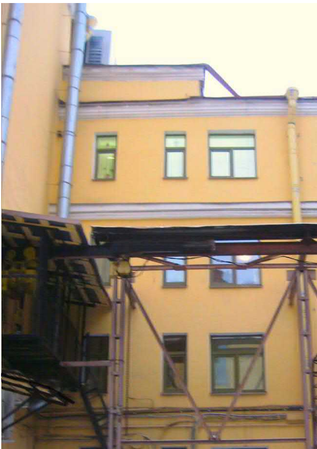
Фото 7. Двор. Существующий воздуховод вентиляции вытяжной системы душевых
