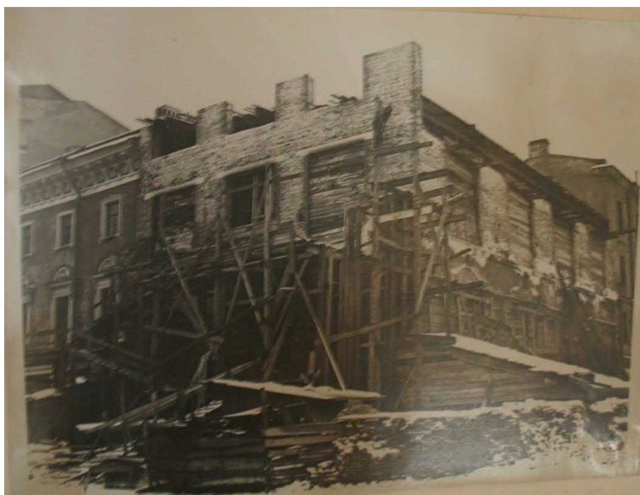
Илл. 25. Строительство репетиционных залов и гримборных на месте электростанции театра.1936-1937 гг. Фото из собрания театра.
