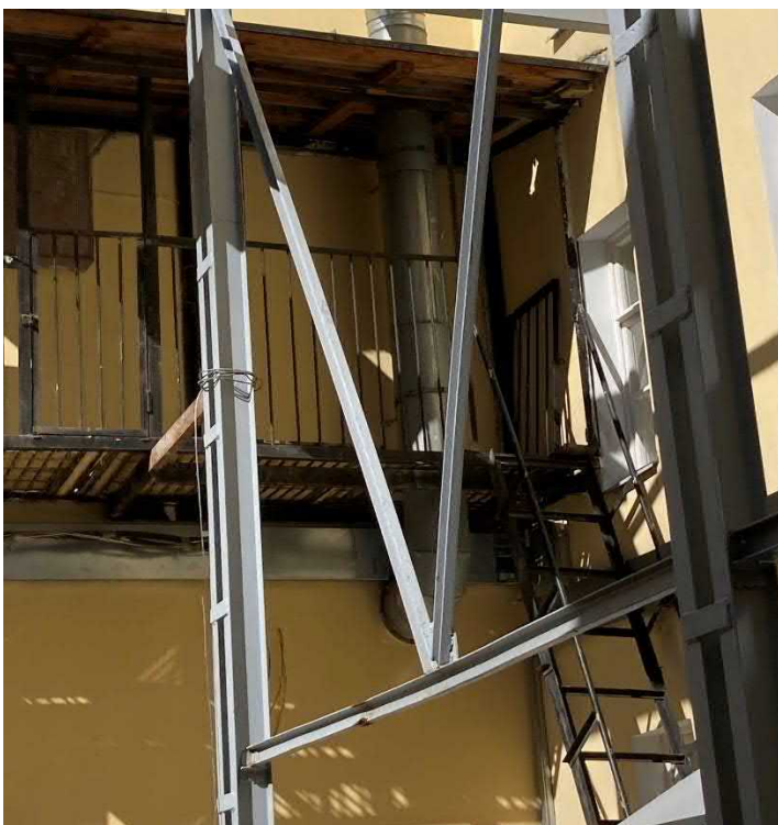
Фото 8. Двор. Существующий воздуховод вентиляции вытяжной системы душевых
