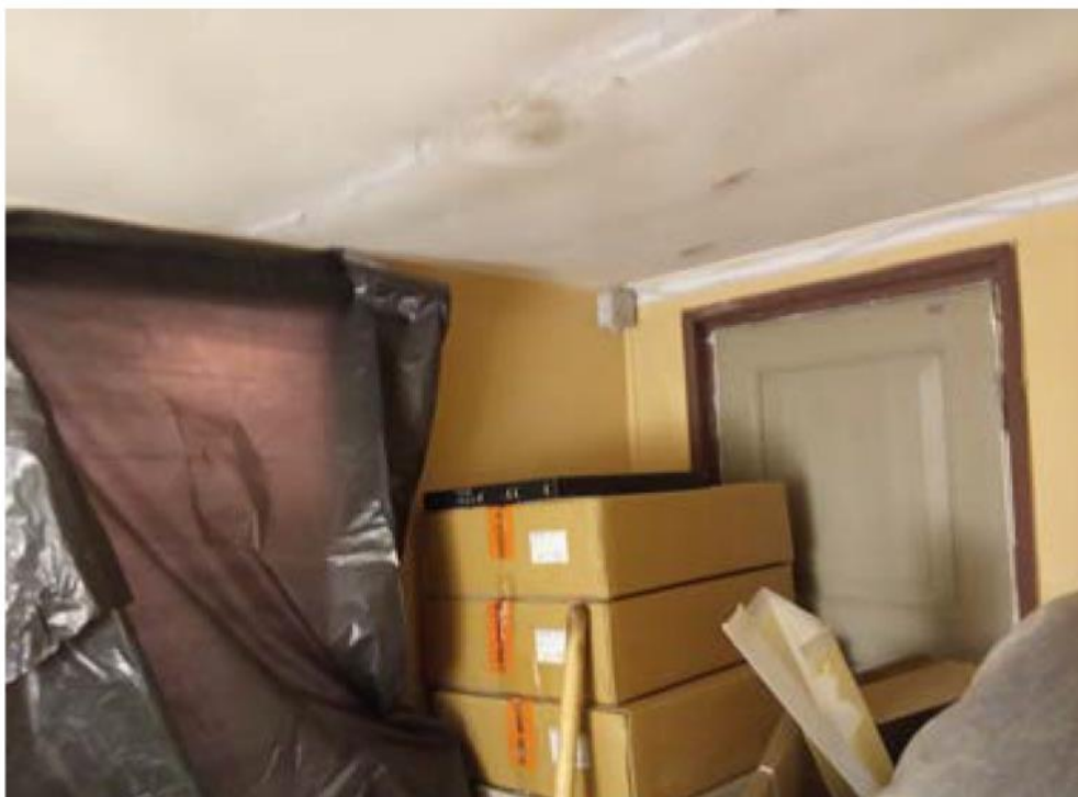
46. Объект культурного наследия федерального значения «Здание Двенадцати Коллегий», расположенный по адресу: г. Санкт-Петербург, Университетская наб., д.7-9-11, литера А, входящий в состав объекта культурного наследия федерального значения «Императорский Санкт-Петербургский университет», расположенный по адресу: г. Санкт-Петербург, Университетская наб., д.7-9, Менделеевская линия, д. 2. Помещение №33. Фрагмент интерьера.
