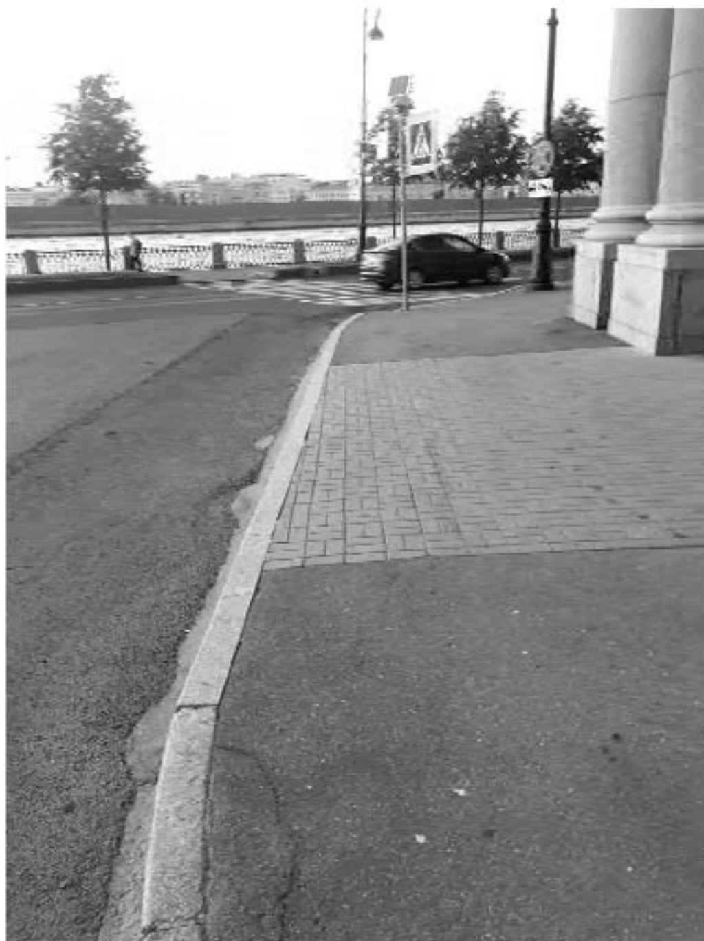
Фото №5. Фрагмент дорожного покрытия и бордюра перед парадным входом в здание по адресу наб. Макарова д. 8
