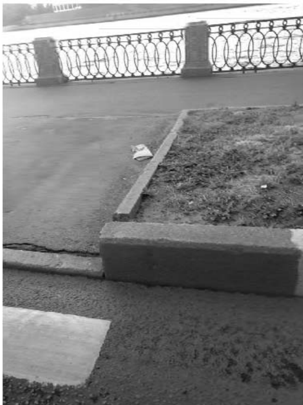
Фото №10. Фрагмент стыка бортовых камней у пешеходного перехода со стороны пешеходной части вдоль р. Малая Нева
