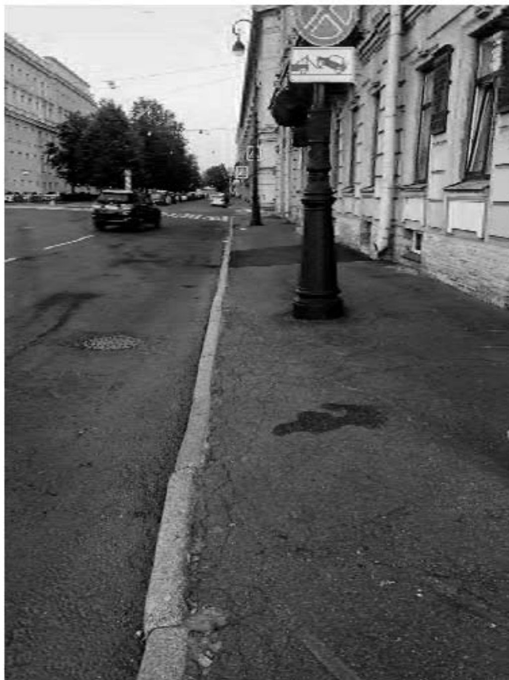
Фото №27. Фрагмент дорожного покрытия на пешеходной дорожке по Биржевой ул. вдоль дома по адресу Биржевая линия 16
