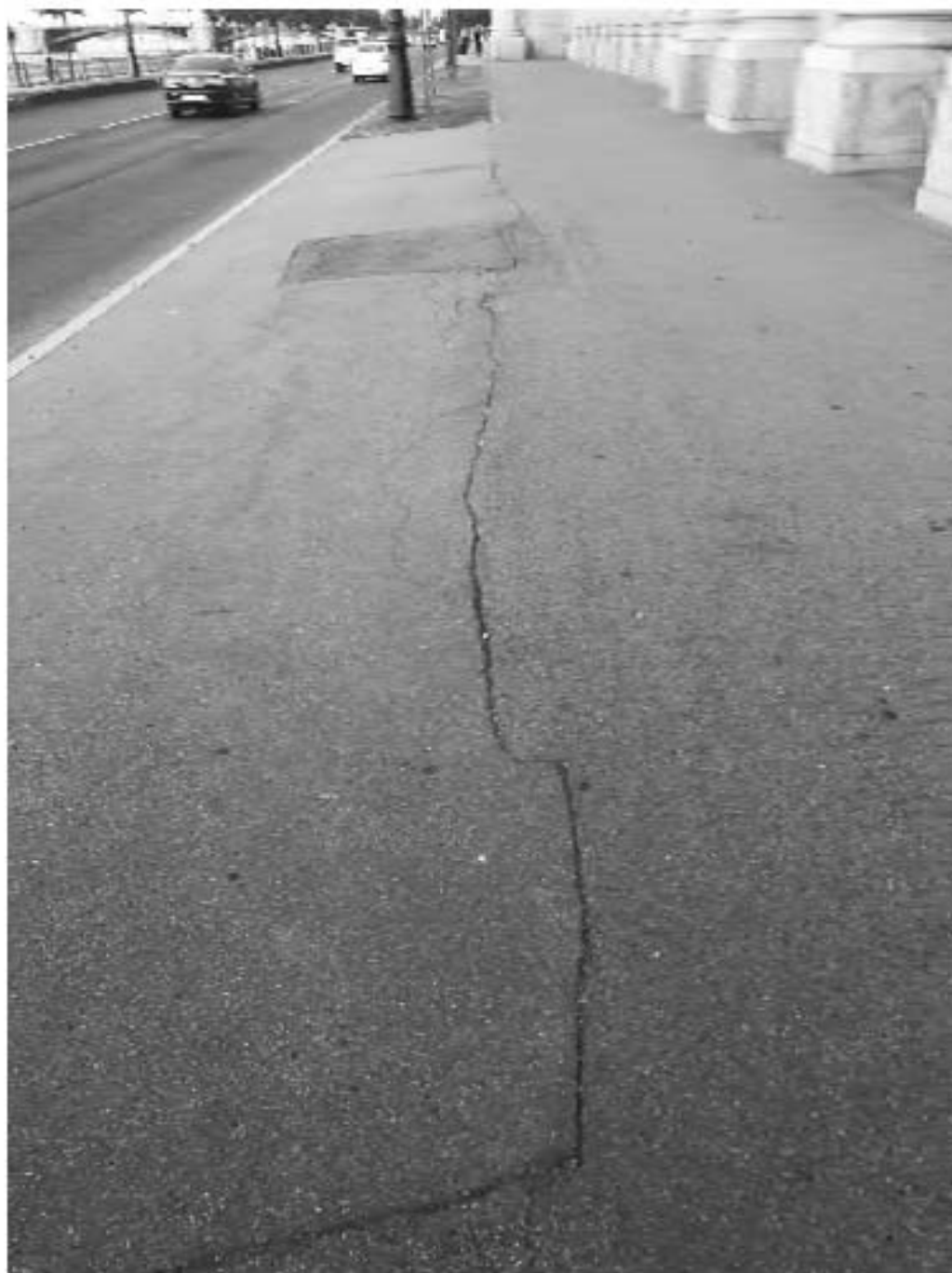
Фото №13. Фрагмент дорожного покрытия на пешеходной тротуаре вдоль дома по адресу наб. Макарова д.8
