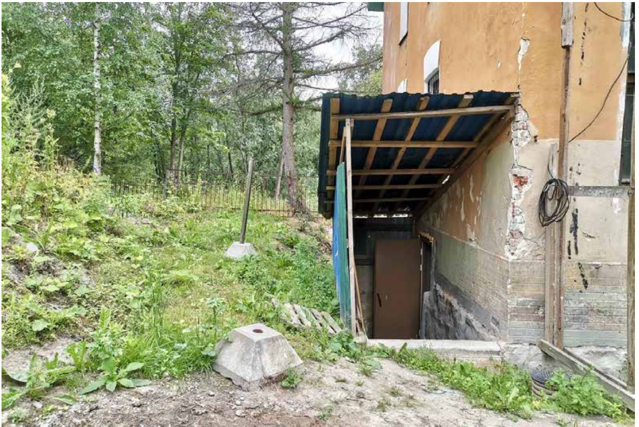
Фото 15. Выявленный ОКН «Павловская электрическая станция (с 2 службами и оградой)». Здание Павловской электростанции (г. Павловск, ул. Надгорная, д. 16 лит. А). Вид с северо-востока. Фрагмент. Съёмка 20.07.2021 г.
