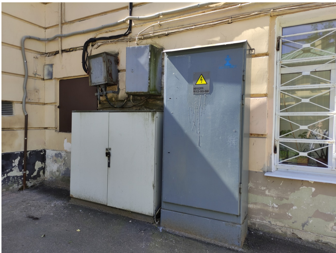
Фото 3. Электрощитовое оборудование. Вид с северо-востока.
