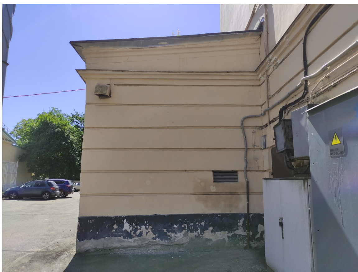
Фото 2. Вид на трансформаторную подстанцию с севера.
