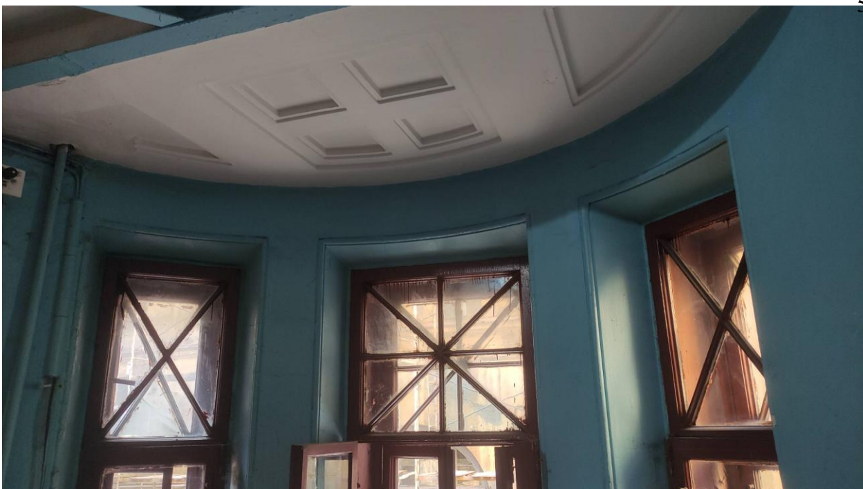
Фото 13. Оконные заполнения парадной лестничной клетки выявленного объекта культурного наследия «Дом Т.М. Любищевой»
