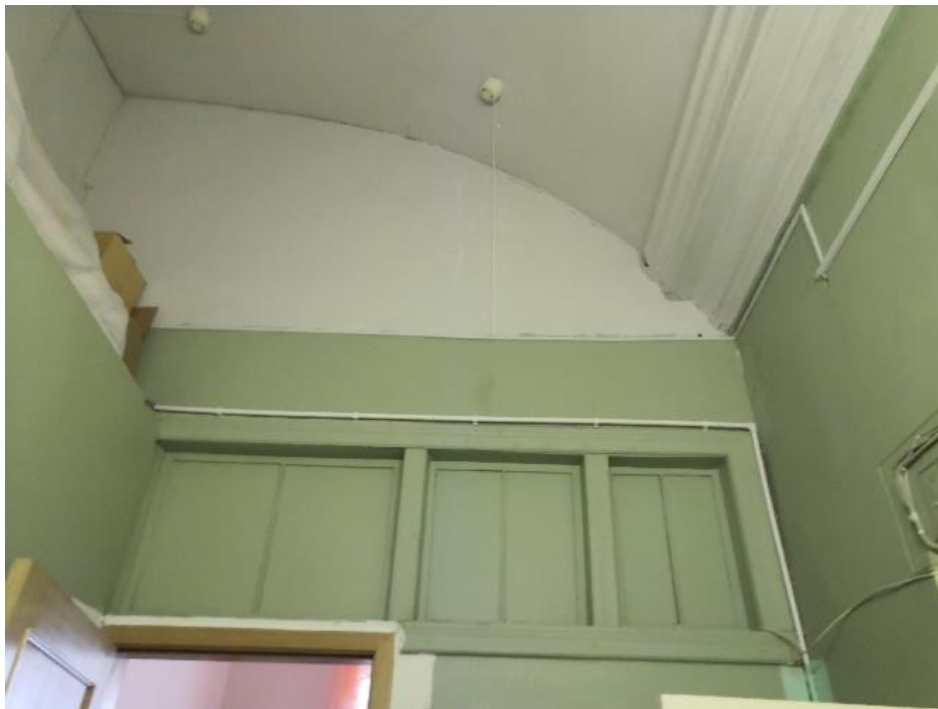
36. Объект культурного наследия федерального значения «Дом Демидова П.Г.», входящий в состав объекта культурного наследия федерального значения «Усадьба Демидовых», по адресу: г. Санкт-Петербург, пер. Гривцова, д. 5, лит. А (Гривцова пер., 1). Помещение 8-Н. В процессе эксплуатации в ряде помещений выполнена перепланировка с устройством перегородок и перебивкой отделки сводов помещений.
