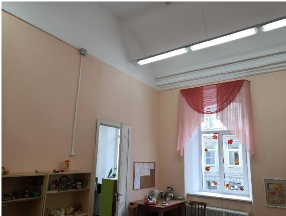
26. Объект культурного наследия федерального значения «Дом Демидова П.Г.», входящий в состав объекта культурного наследия федерального значения «Усадьба Демидовых», по адресу: г. Санкт-Петербург, пер. Гривцова, д. 5, лит. А (Гривцова пер., 1). Помещение 8-Н (помещение №12, фрагмент интерьера).
