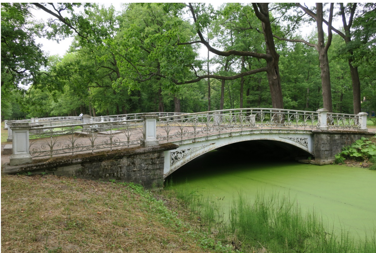
1. Низовой восточный фасад объекта культурного наследия федерального значения «МостMetalлический», расположенного по адресу: Санкт-Петербург, г. Пушкин, Александровский парк, литера БА. Вид с юго-востока. 01.07.2021
