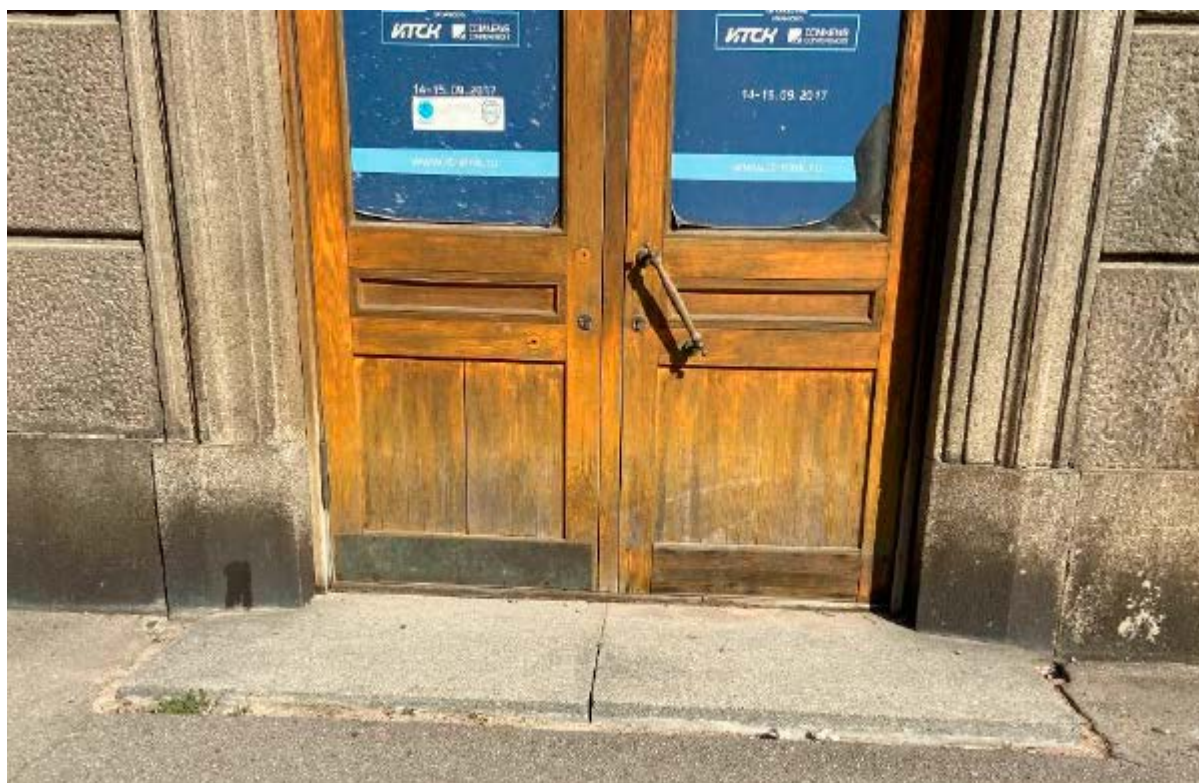
8. Дверное заполнение лицевого фасада по улице Почтамтской объекта культурного наследия регионального значения «Здание Управления городского телефона и телеграфа», расположенного по адресу: г. Санкт-Петербург, Почтамтская ул., 15, литера Б. Фрагмент. 15.08.2021.
