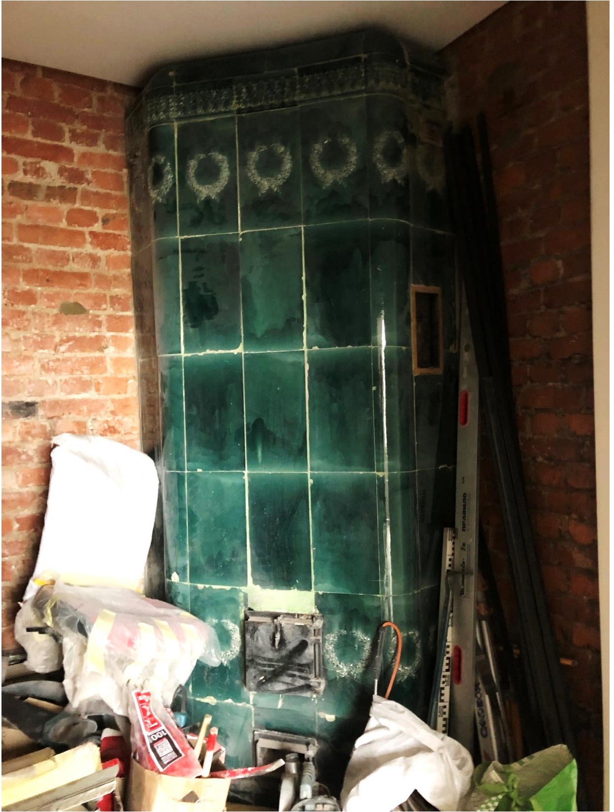
Фото 14. Печь в помещении № 3 (ба-Н).
