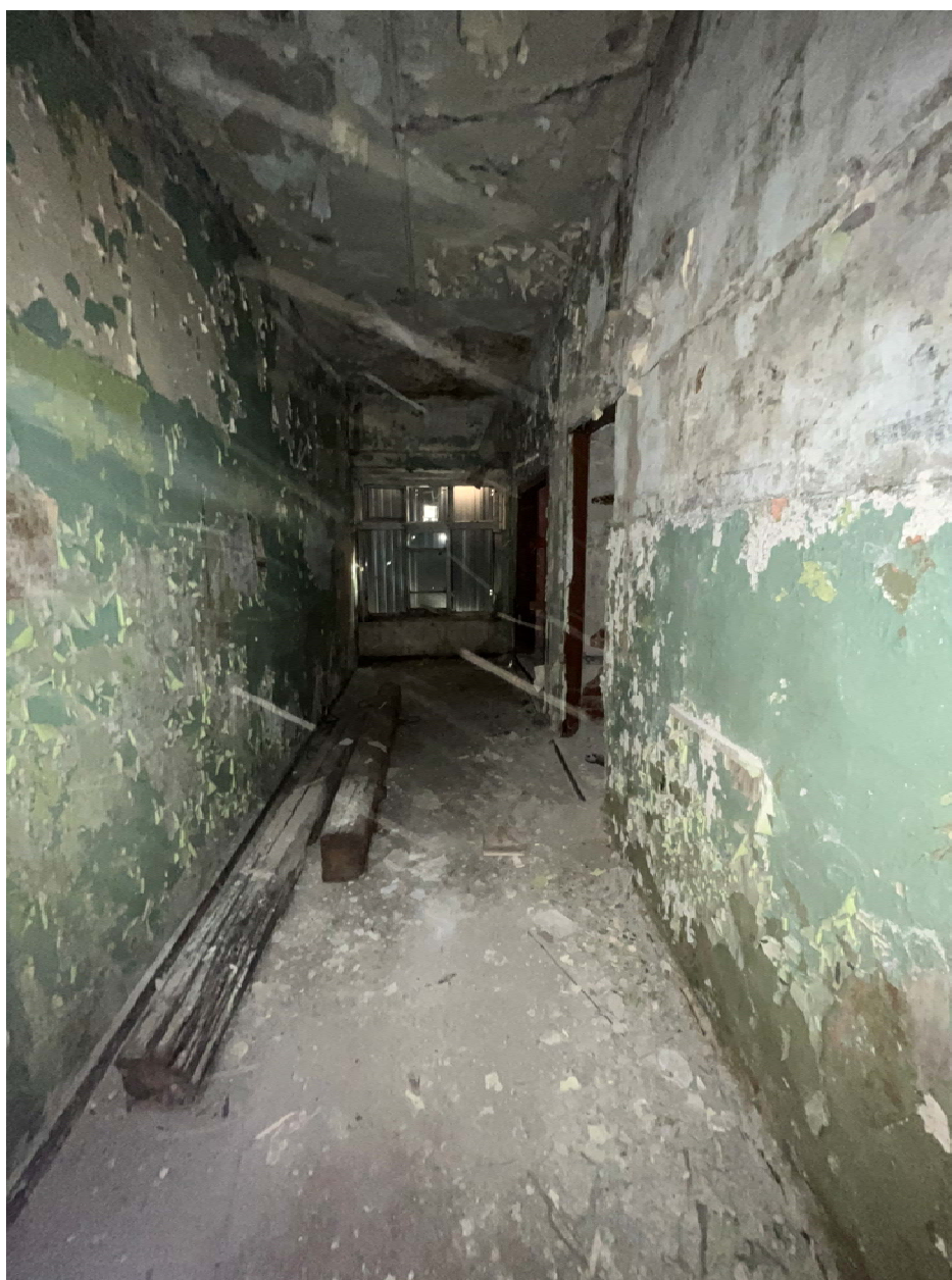
Фото №32. Объект культурного наследия регионального значения «Сельдяной ряд Никольского рынка», помещения второго этажа.
