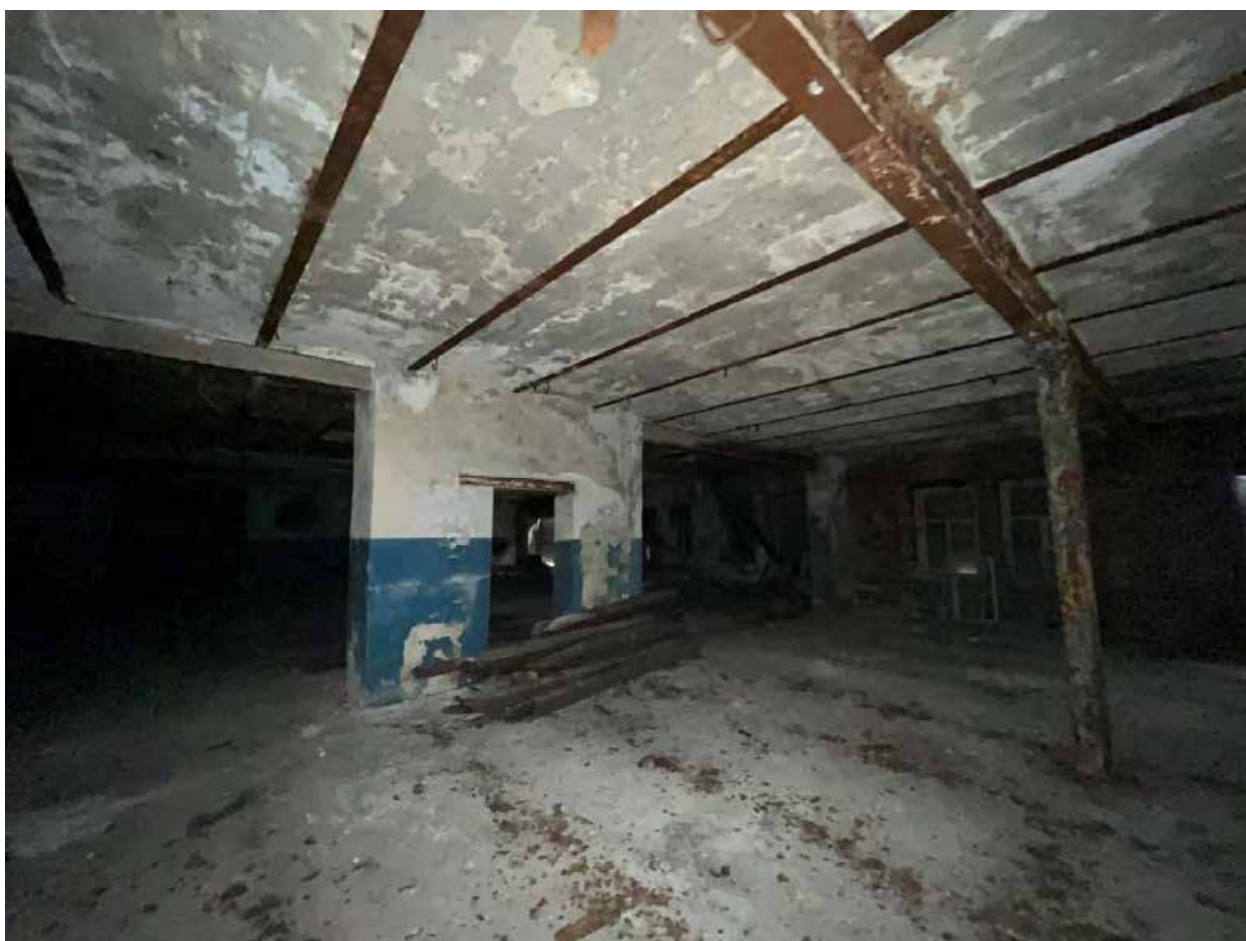
Фото №39. Объект культурного наследия регионального значения «Сельдяной ряд Никольского рынка», помещения третьего этажа.
