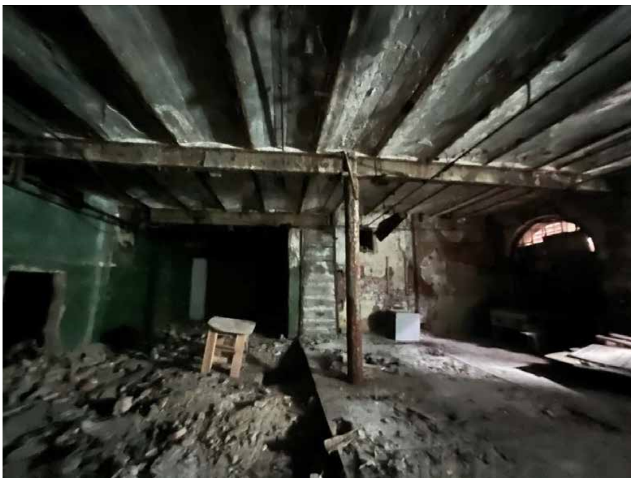
Фото №19. Объект культурного наследия регионального значения «Сельдяной ряд Никольского рынка», подвал, пом. 5-Н (?).
