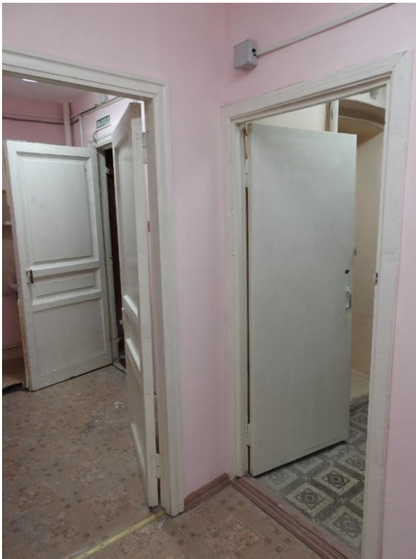
19. «Дом Н.В. Чайковского», ул. Короленко, д. 2, лит. А. Общий вид дверных проёмов в помещение кладовой и выхода на дворовую лестницу. Фото 05.04.2023г.
