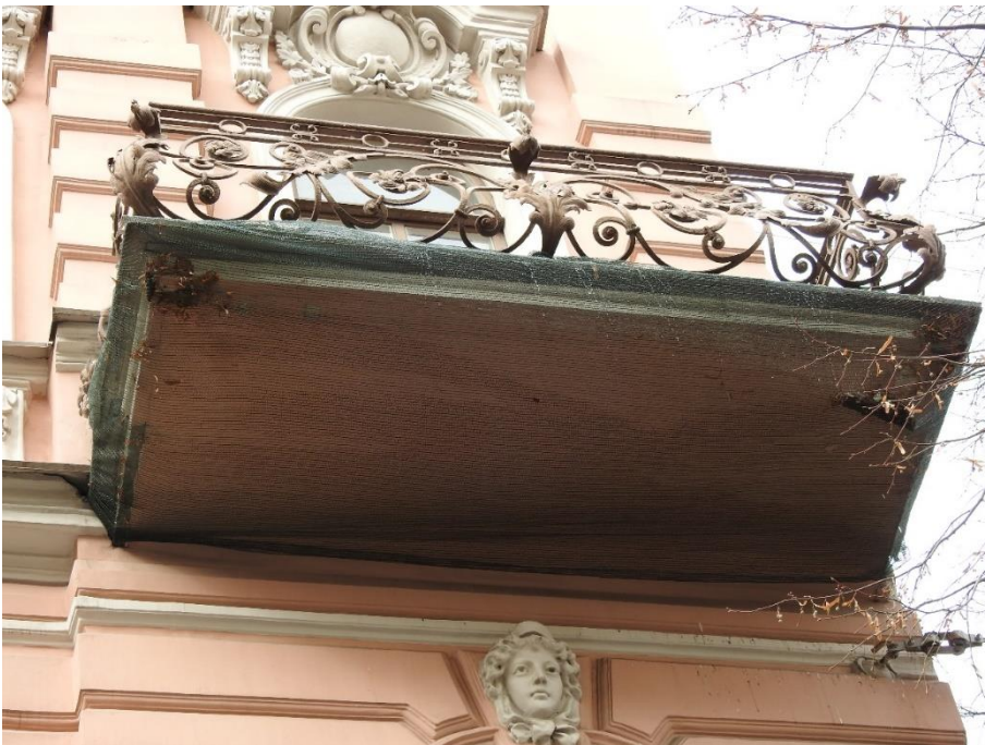
12. «Дом Н.В. Чайковского», ул. Короленко, д. 2, лит. А. Фрагмент фасада по ул. Короленко. Фото 05.04.2023г.
