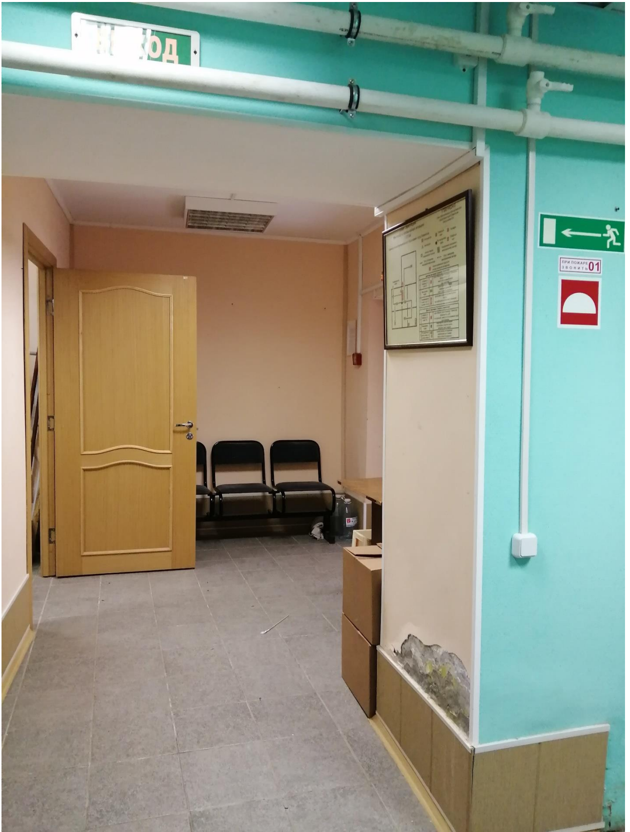
Фото 12. Объект культурного наследия регионального значения «Жилой дом», расположенный по адресу: Санкт-Петербург, город Ломоносов, Дворцовый проспект, д.40, лит.Б. Помещение 20-Н (2). Следы намокания стены.
