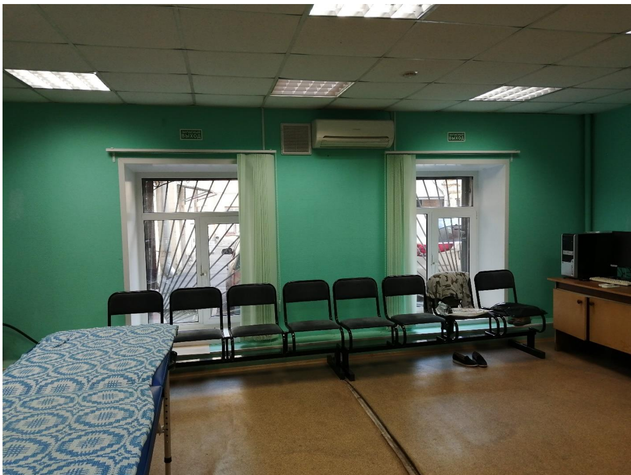
Фото 16. Объект культурного наследия регионального значения «Жилой дом», расположенный по адресу: Санкт-Петербург, город Ломоносов, Дворцовый проспект, д.40, лит.Б. Помещение 20-Н (5). Слева- вновь устроенный оконный проем в капитальной стене. Дефект покрытия пола.
