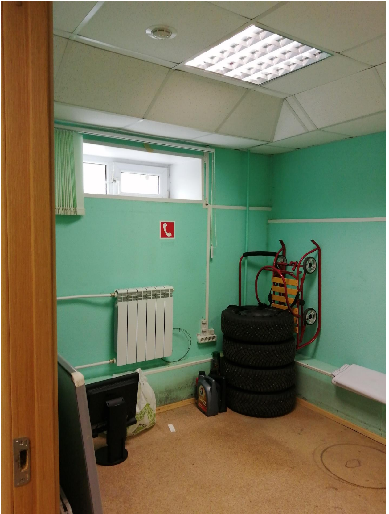
Фото 18. Объект культурного наследия регионального значения «Жилой дом», расположенный по адресу: Санкт-Петербург, город Ломоносов, Дворцовый проспект, д.40, лит.Б. Помещение 20-Н (4). Часть помещения отделена вновь устроенной перегородкой, следы намокания стены.
