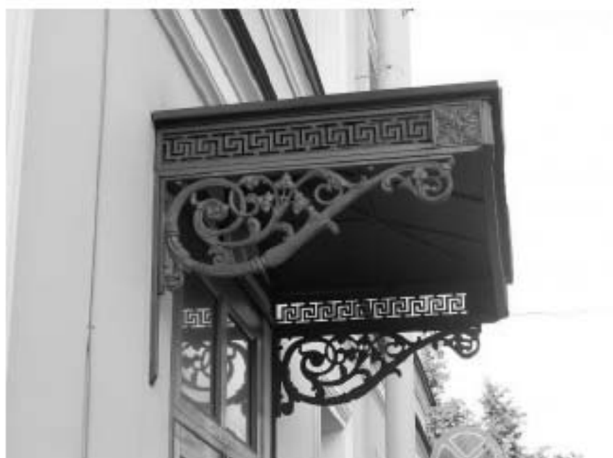
70. Бывший Николаевский дом призрения престарелых и увечных граждан Санкт-Петербургского купеческого общества. Крыльцо со стороны Расстанной улицы. Козырек. Фотография. Март 2013. www.citywalls.ru .
