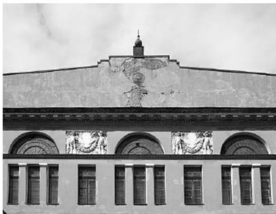
63. Бывший Николаевский дом призрения престарелых и увечных граждан Санкт-Петербургского купеческого общества. Главное здание. Главный фасад (фрагмент). Фотография. 2000-е гг. www.citywalls.ru
