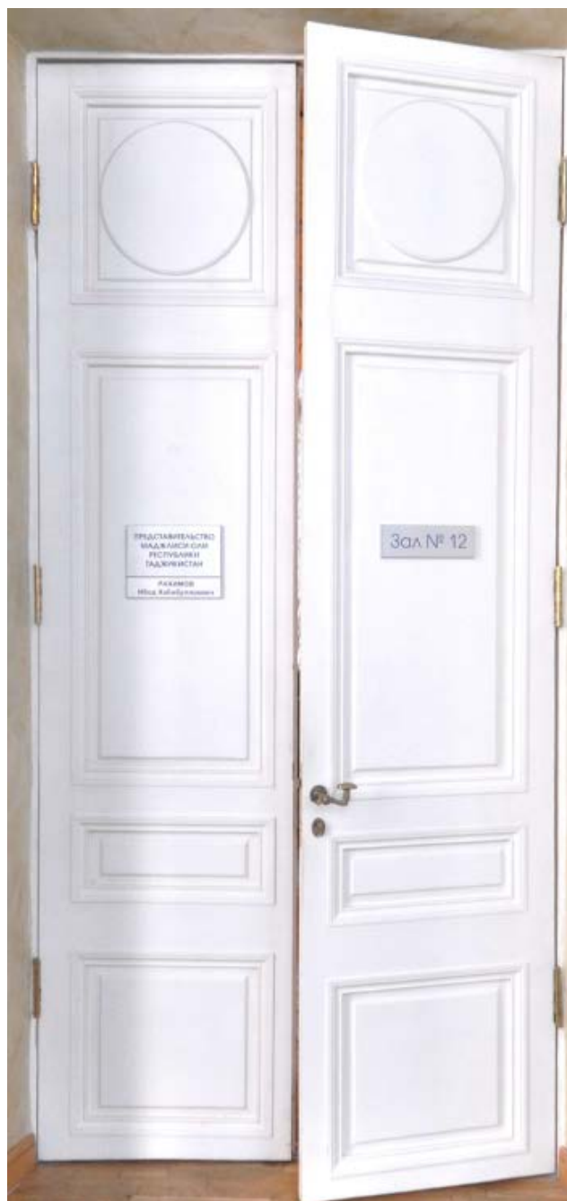
10. Заполнение дверного проема северной стены помещения зала №12 (пом. 1-Н (136) в уровне 1-ого этажа объекта культурного наследия федерального значения «Дворец Таврический. Дворец». 10.05.2021
