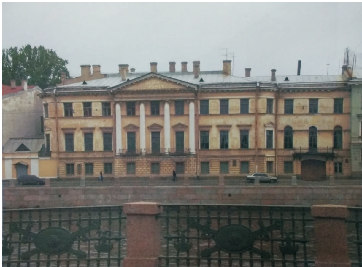
Ил. 61. Наб. р. Фонтанки, 20. Лицевой фасад до реставрации. Фото 2005 г. (?) Оpubл.: КГИОП. п.179. №-7799. Дом Неклюдова П.В. (Дом Министерства Императорского Двора «Дом Голицына») наб. р. Фонтанки, д. 20. Отчет о реставрации / РПНЦ «Специалист». СПб., 2005. Ил. 1.
