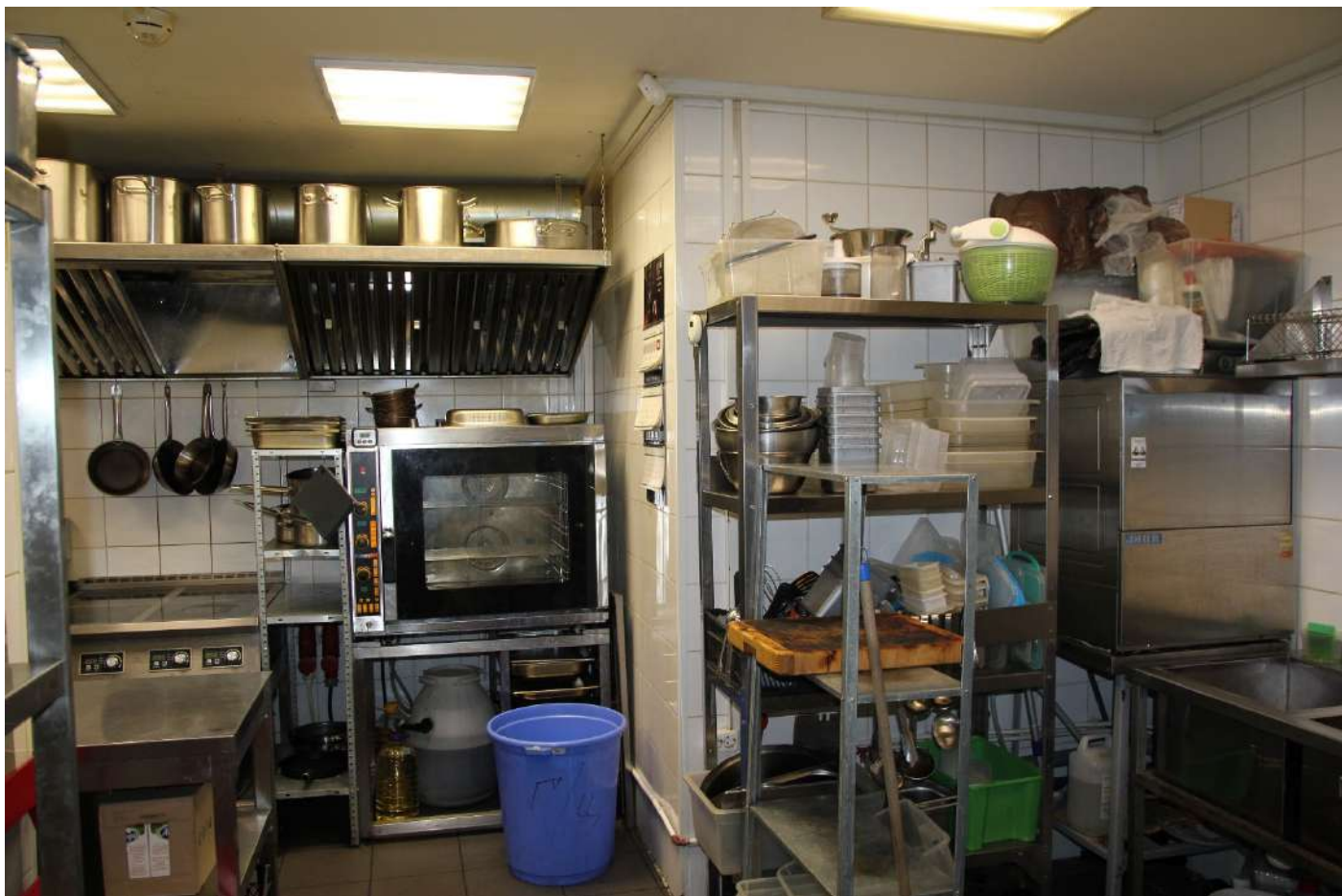
Фото№20: Вид на оборудование кухни
