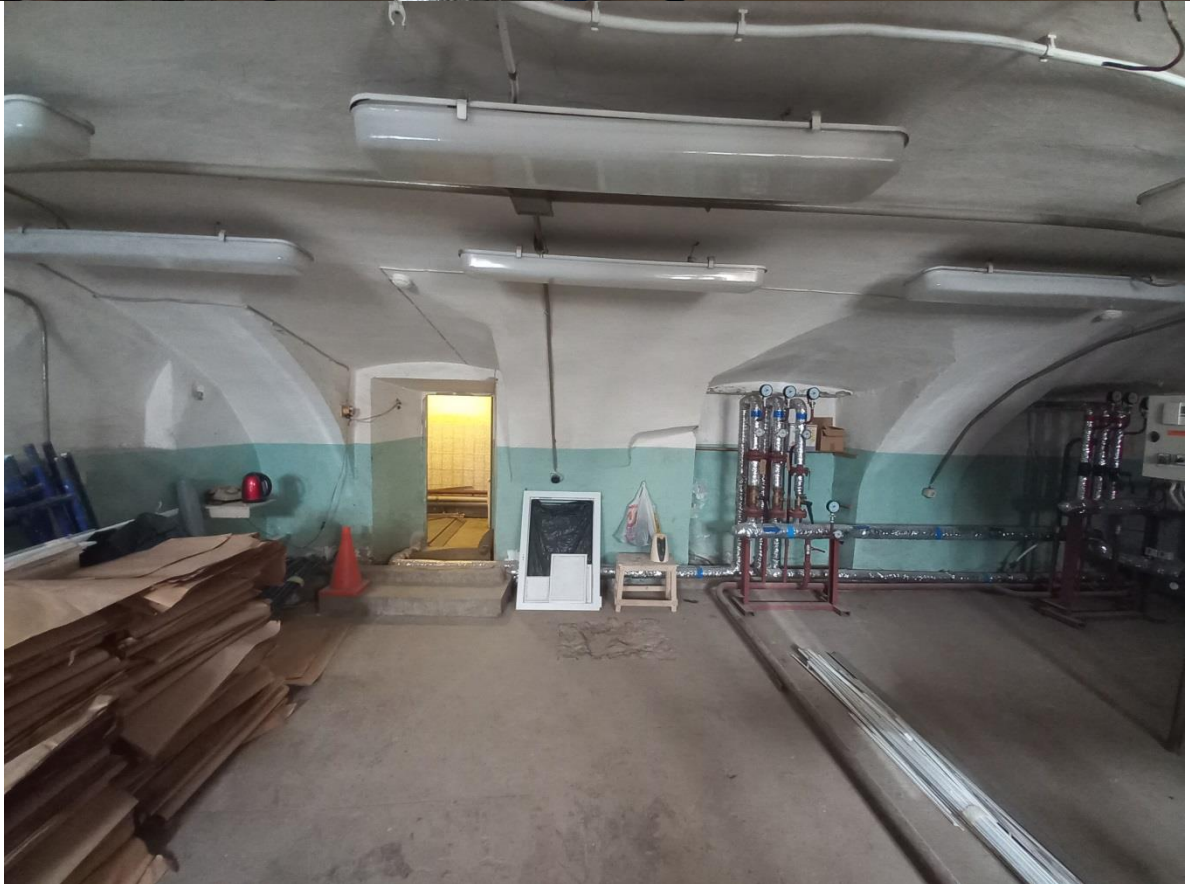
Фото 15 и 16. Помещение 21. Теплоцентр.
