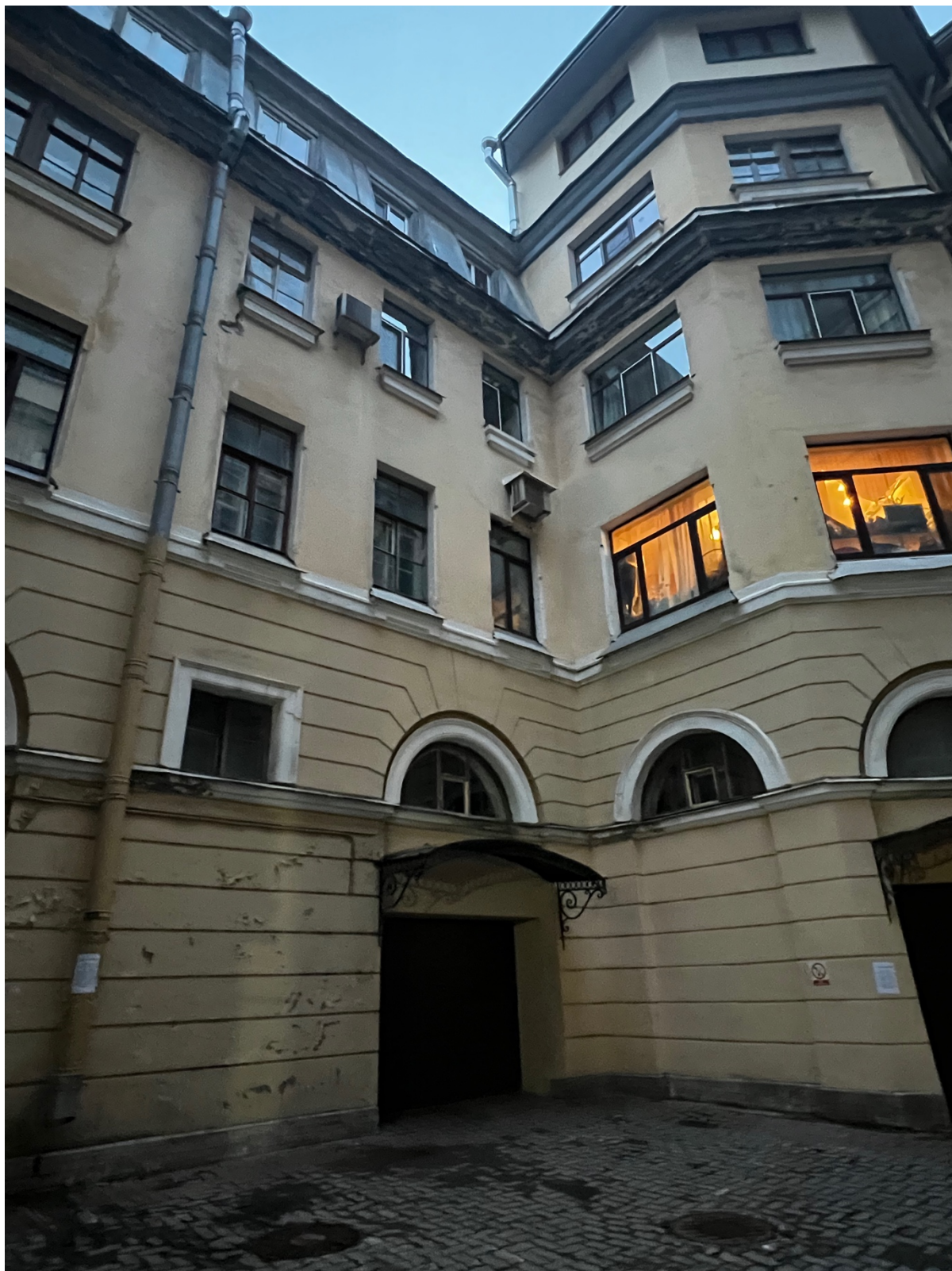
Фото 5. Вид на часть дворового фасада, наблюдается установка дополнительного оборудования, замена оконных заполнений.
