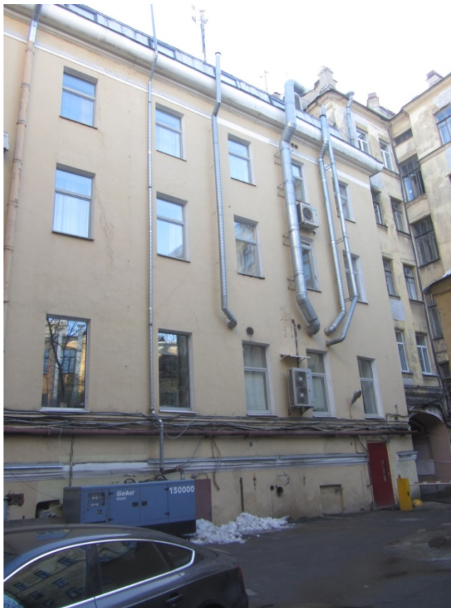
9. Вид дворовых фасадов объекта культурного наследия «Здание Мариинской женской гимназии», расположенного по адресу: Санкт-Петербург, Загородный пр., 13, лит. А.
