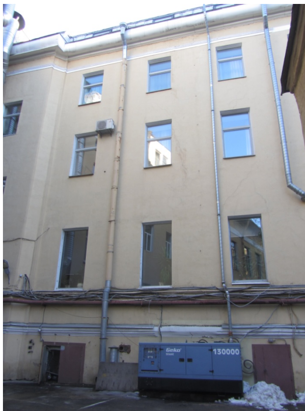
8. Вид дворовых фасадов объекта культурного наследия «Здание Мариинской женской гимназии», расположенного по адресу: Санкт-Петербург, Загородный пр., 13, лит. А.
