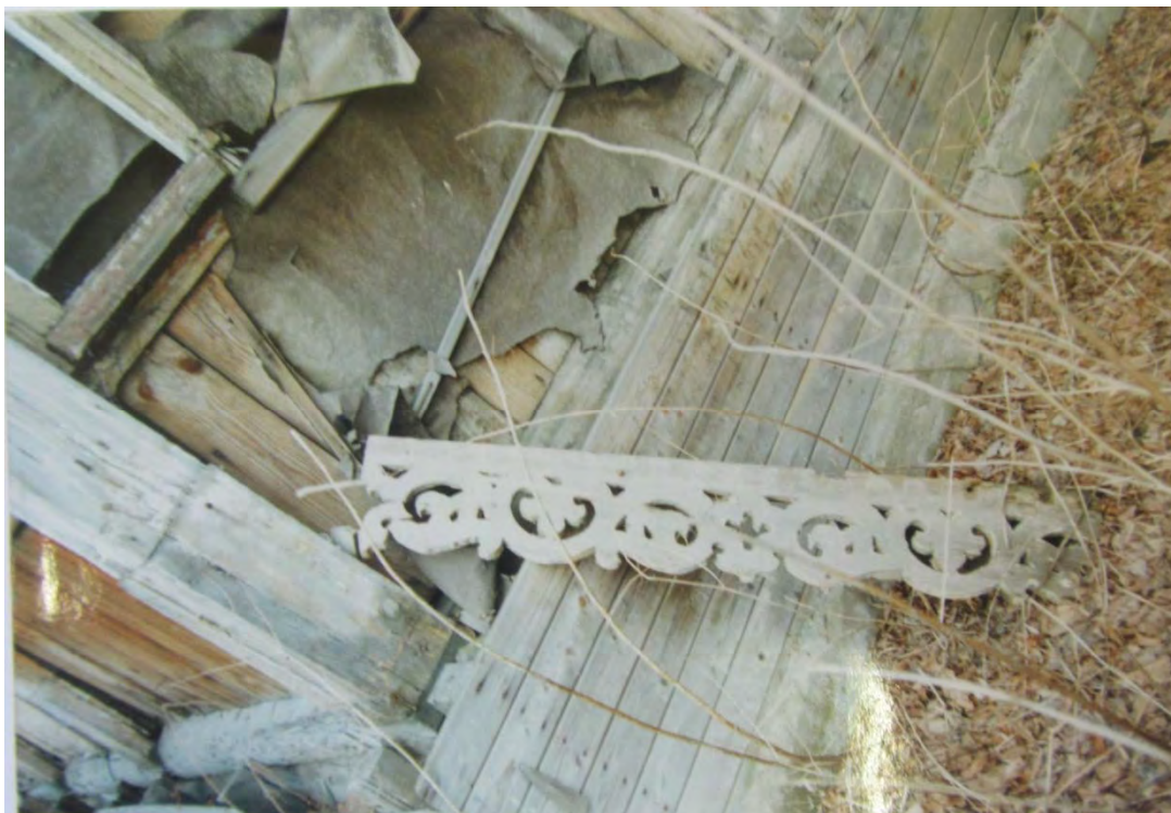
41. 2001г. Бывший дом П. С. Петровой. Фрагмент декора восточного фасада. Архив КГИОП.
