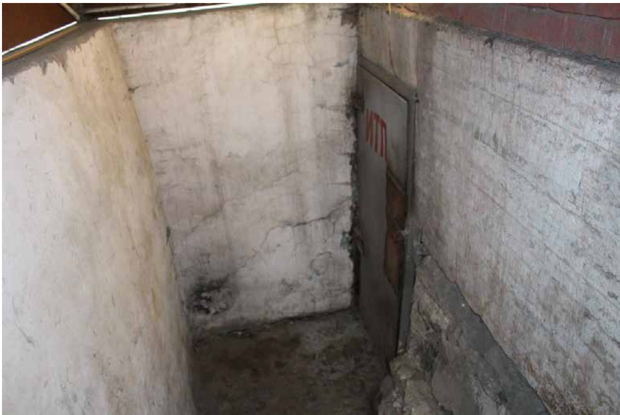
Фото 11. Вход в тепловой пункт (помещение 3-Н).
