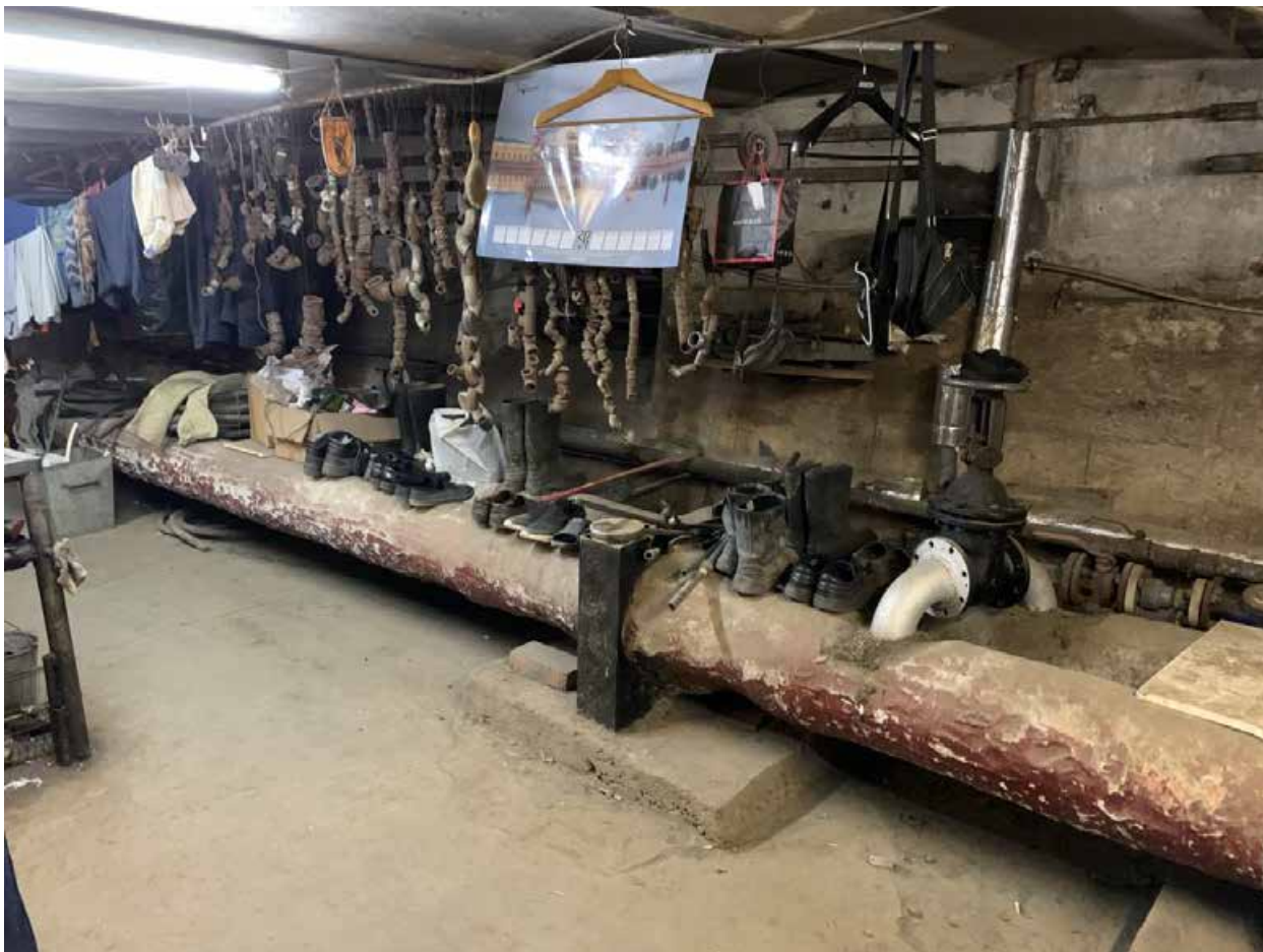
Фото 15. Вид на внутренние помещения теплового пункта (ч.п. 2 помещения 3-Н).
