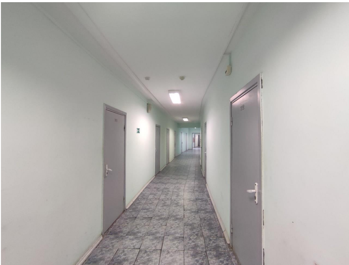
54. Выявленный объект культурного наследия «Здание общежития Транспортной Академии», по адресу: г. Санкт-Петербург, Малая Посадская ул., д. 22-24, лит. А. Фрагмент пом. 102-С (233) в уровне 3-го этажа.
