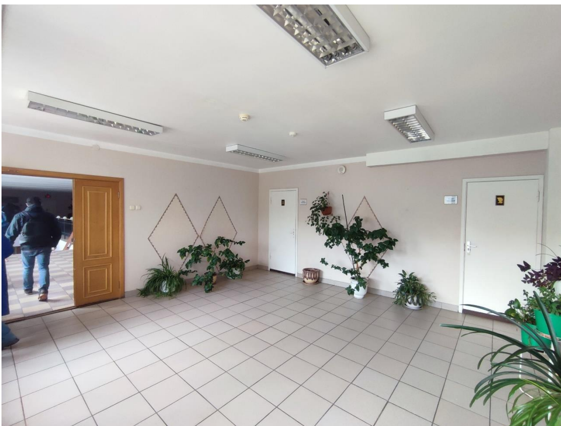
34. Выявленный объект культурного наследия «Здание общежития Транспортной Академии», по адресу: г. Санкт-Петербург, Малая Посадская ул., д. 22-24, лит. А. Общий вид пом. 102-С (128) в уровне 2-го этажа.
