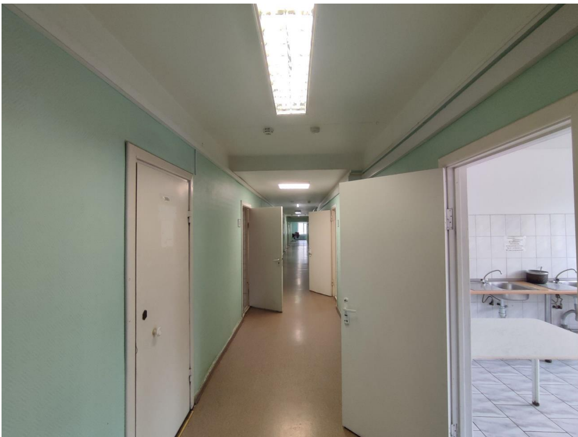
58. Выявленный объект культурного наследия «Здание общежития Транспортной Академии», по адресу: г. Санкт-Петербург, Малая Посадская ул., д. 22-24, лит. А. Общий вид пом. 102-С (232) в уровне 3-го этажа.
