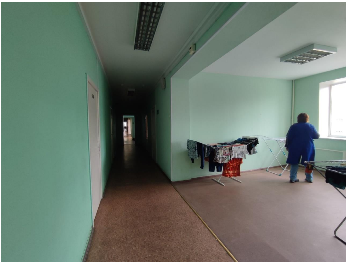
83. Выявленный объект культурного наследия «Здание общежития Транспортной Академии», по адресу: г. Санкт-Петербург, Малая Посадская ул., д. 22-24, лит. А. Общий вид пом. 102-С (428) в уровне 5-го этажа.
