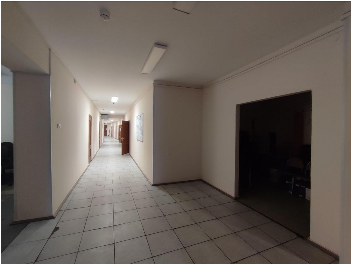
25. Выявленный объект культурного наследия «Здание общежития Транспортной Академии», по адресу: г. Санкт-Петербург, Малая Посадская ул., д. 22-24, лит. А. Фрагмент пом. 102-С (41) в уровне 1-го этажа.
