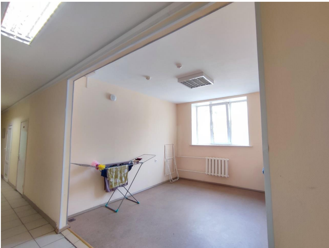
39. Выявленный объект культурного наследия «Здание общежития Транспортной Академии», по адресу: г. Санкт-Петербург, Малая Посадская ул., д. 22-24, лит. А. Общий вид пом. 102-С (117) в уровне 2-го этажа.
