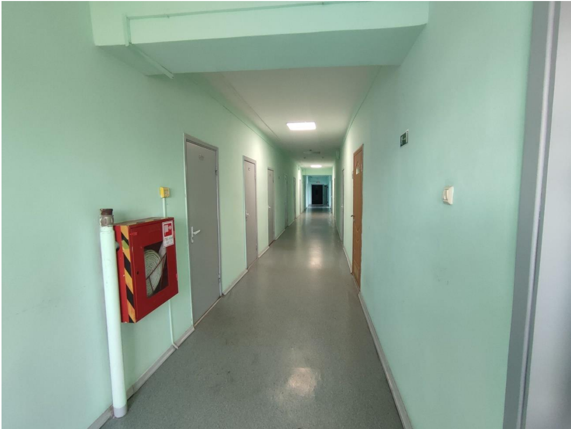
72. Выявленный объект культурного наследия «Здание общежития Транспортной Академии», по адресу: г. Санкт-Петербург, Малая Посадская ул., д. 22-24, лит. А. Общий вид пом. 102-С (481) в уровне 5-го этажа.
