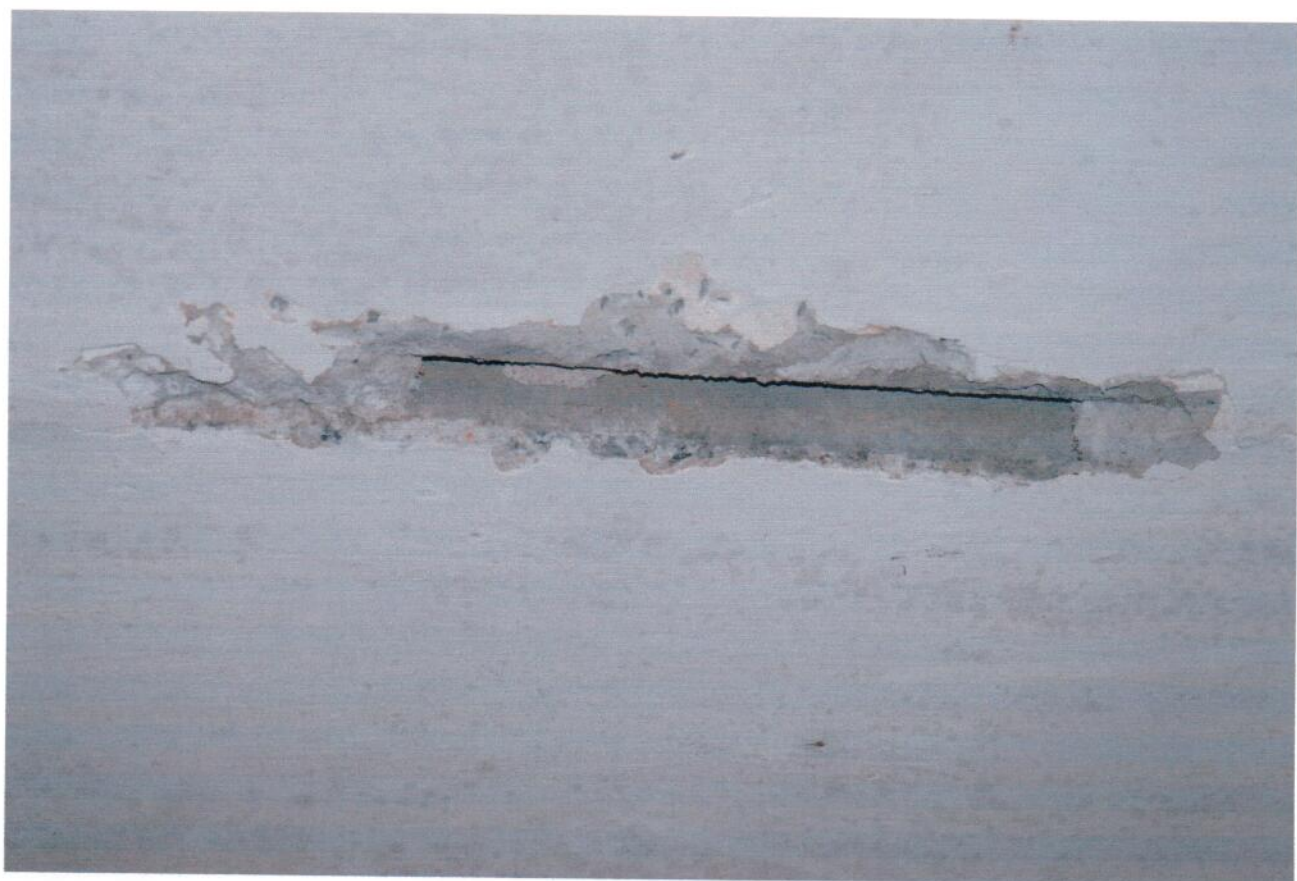
Трещина перекрытия между 1 и 2 этажами (увеличено)
