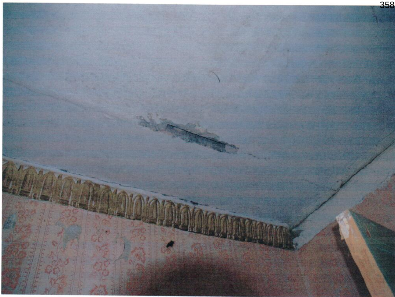
Трещина перекрытия между 1 и 2 этажами
