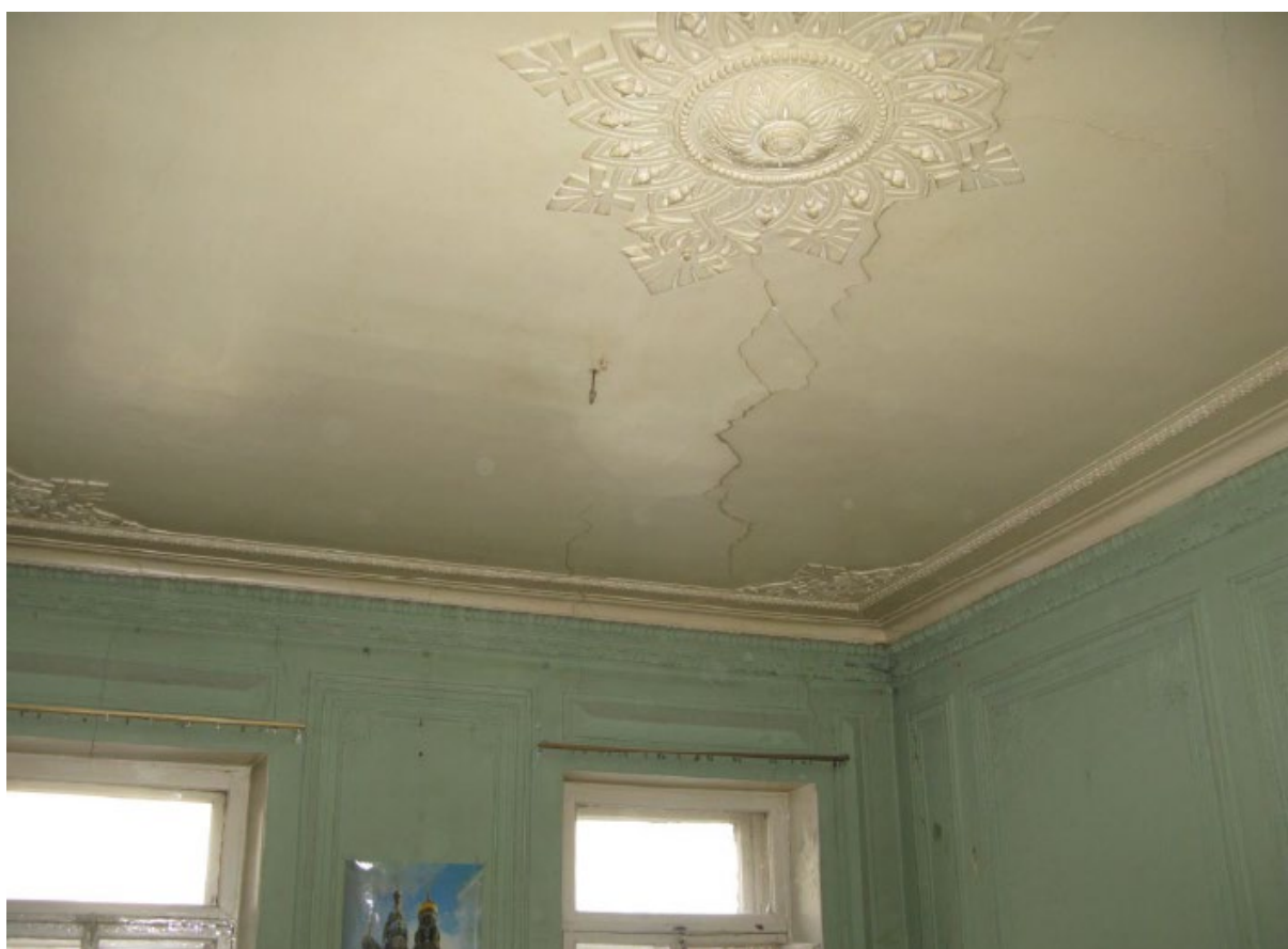
7. Помещение № 10 квартиры №14 в уровне 4-го этажа объекта культурного наследия федерального значения «Дом, где в 1887-1891 гг. жил композитор Рубинштейн А.Г. Здесь в 1905-1906 гг. проходили заседания ЦК РСДРП», расположенного по адресу: г. Санкт-Петербург, Загородный пр., д. 9, литера А. 15.09.2022
