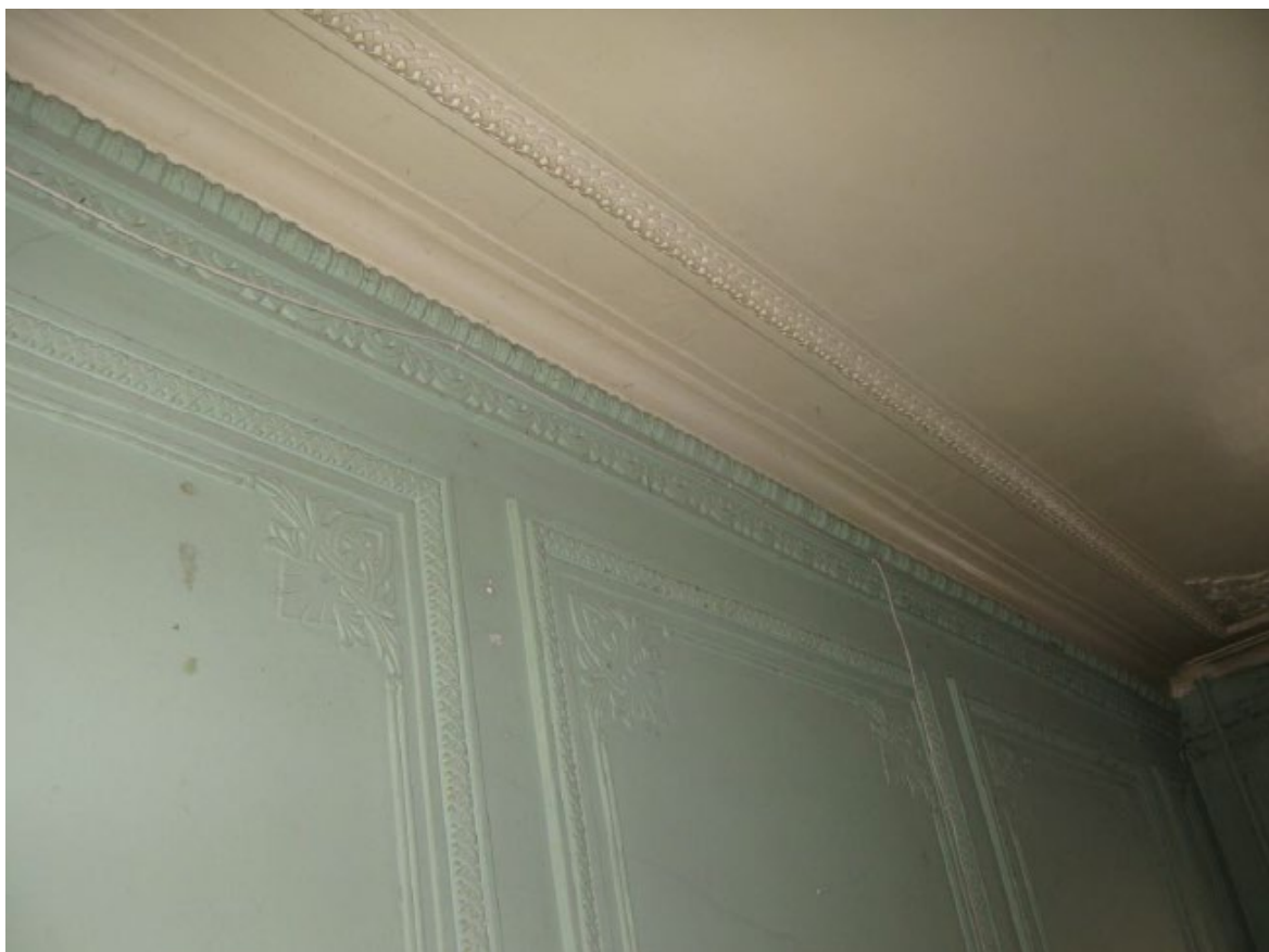
12. Помещение № 10 квартиры №14 в уровне 4-го этажа объекта культурного наследия федерального значения «Дом, где в 1887-1891 гг. жил композитор Рубинштейн А.Г. Здесь в 1905-1906 гг. проходили заседания ЦК РСДРП», расположенного по адресу: г. Санкт-Петербург, Загородный пр., д. 9, литера А. 15.09.2022
