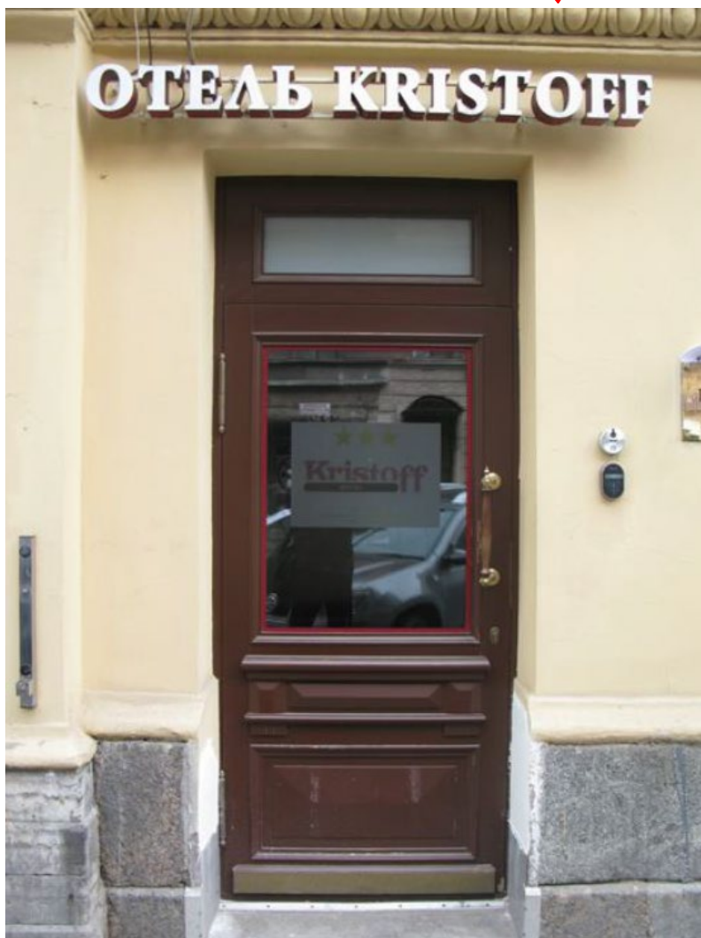
30. Входное заполнение в помещение 30-Н объекта культурного наследия федерального значения «Дом, где в 1887-1891 гг. жил композитор Рубинштейн А.Г. Здесь в 1905-1906 гг. проходили заседания ЦК РСДРП», расположенного по адресу: г. Санкт-Петербург, Загородный пр., д. 9, литера А. 15.09.2022
