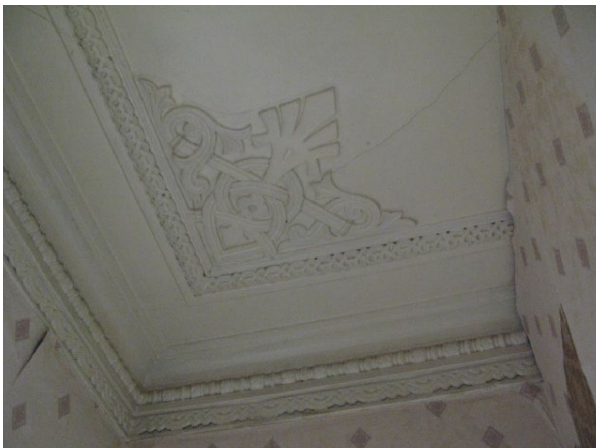
23. Помещение № 15 квартиры №13 в уровне 4-го этажа объекта культурного наследия федерального значения «Дом, где в 1887-1891 гг. жил композитор Рубинштейн А.Г. Здесь в 1905-1906 гг. проходили заседания ЦК РСДРП», расположенного по адресу: г. Санкт-Петербург, Загородный пр., д. 9, литера А. 15.09.2022
