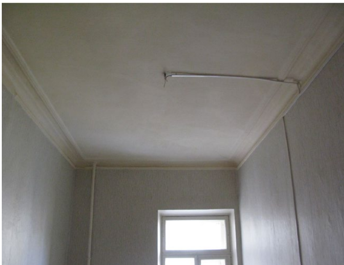
14. Помещение № 13 квартиры №14 в уровне 4-го этажа объекта культурного наследия федерального значения «Дом, где в 1887-1891 гг. жил композитор Рубинштейн А.Г. Здесь в 1905-1906 гг. проходили заседания ЦК РСДРП», расположенного по адресу: г. Санкт-Петербург, Загородный пр., д. 9, литера А. 15.09.2022
