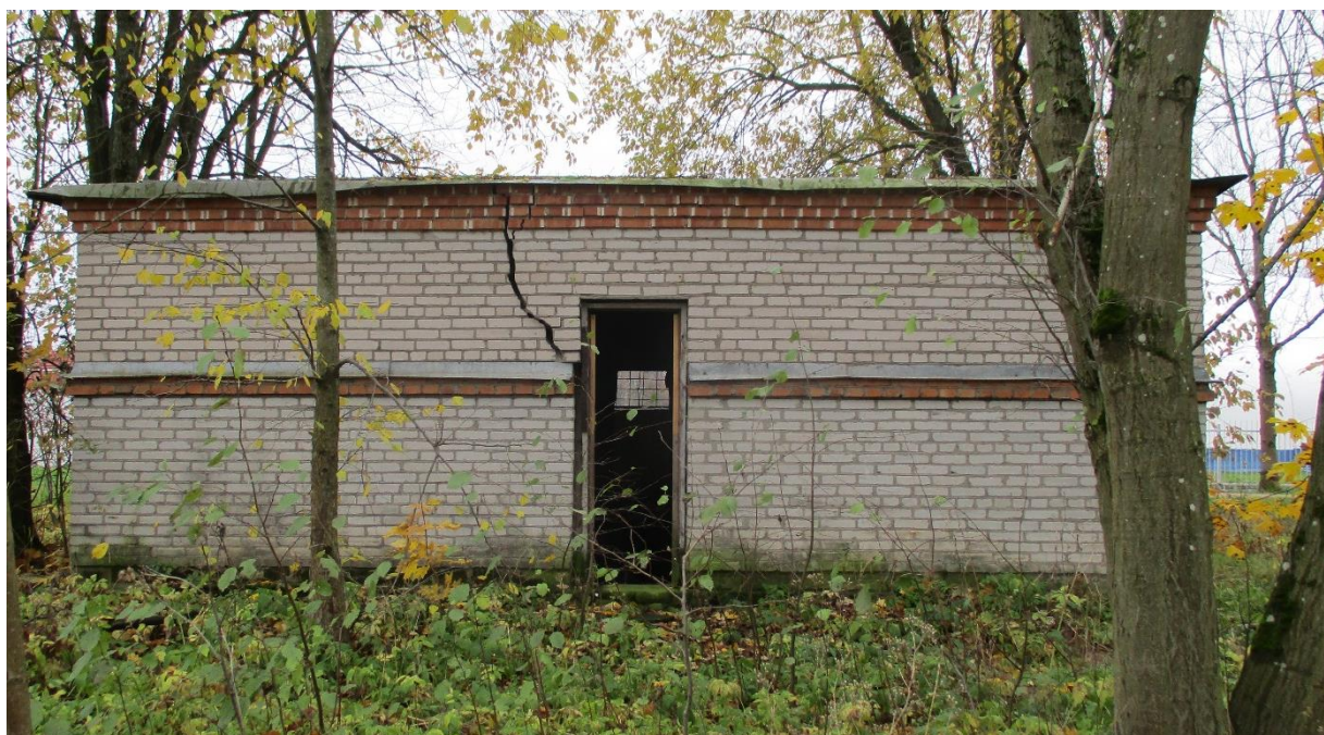
4. Северо-западный фасад здания туалета, расположенного на территории объекта культурного наследия федерального значения «Александровский парк», расположенного по адресу: Санкт-Петербург г. Пушкин, Дворцовая ул., 2. 10.10.2022
