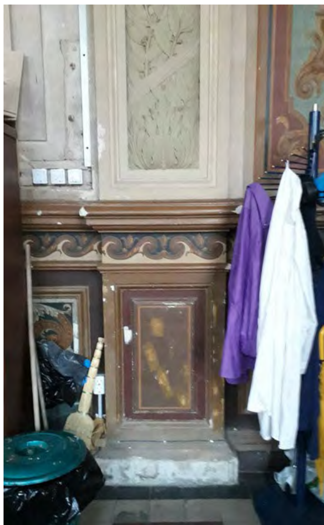
Фото 21. Объект культурного наследия федерального значения "Центральное училище технического рисования и музей Штиглица А.Л" по адресу: Санкт-Петербург, Соляной пер., д. 13-15, лит. А. Помещения 288-Н (Зал Людовика XIV)
